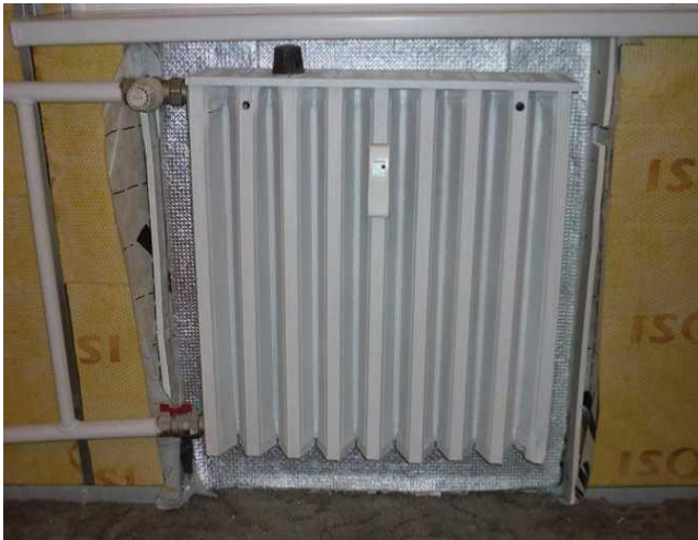
Slika 5.1.5. Izolacija zida iza radijatora
