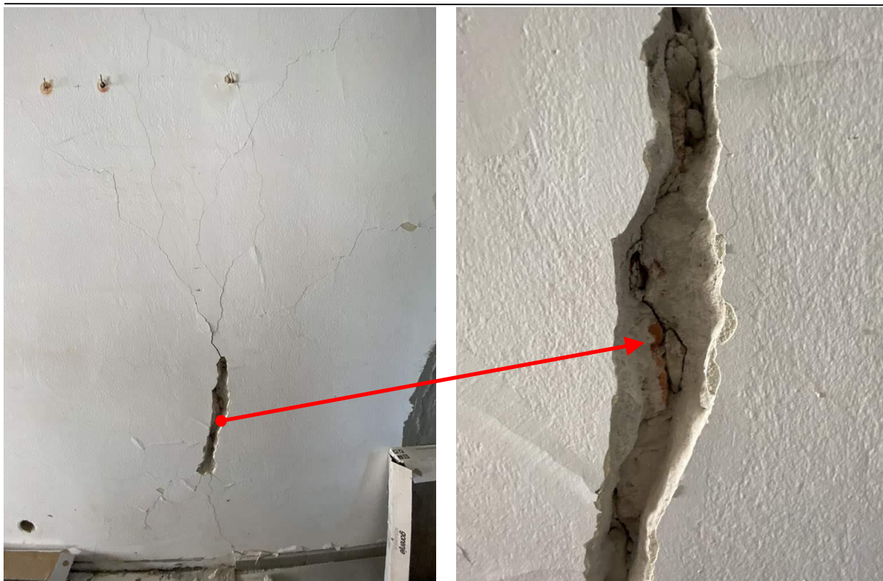
Slika 4.14. Unutrašnji zidovi prizemlja etaže 2, pukotina pregradnog zida;
