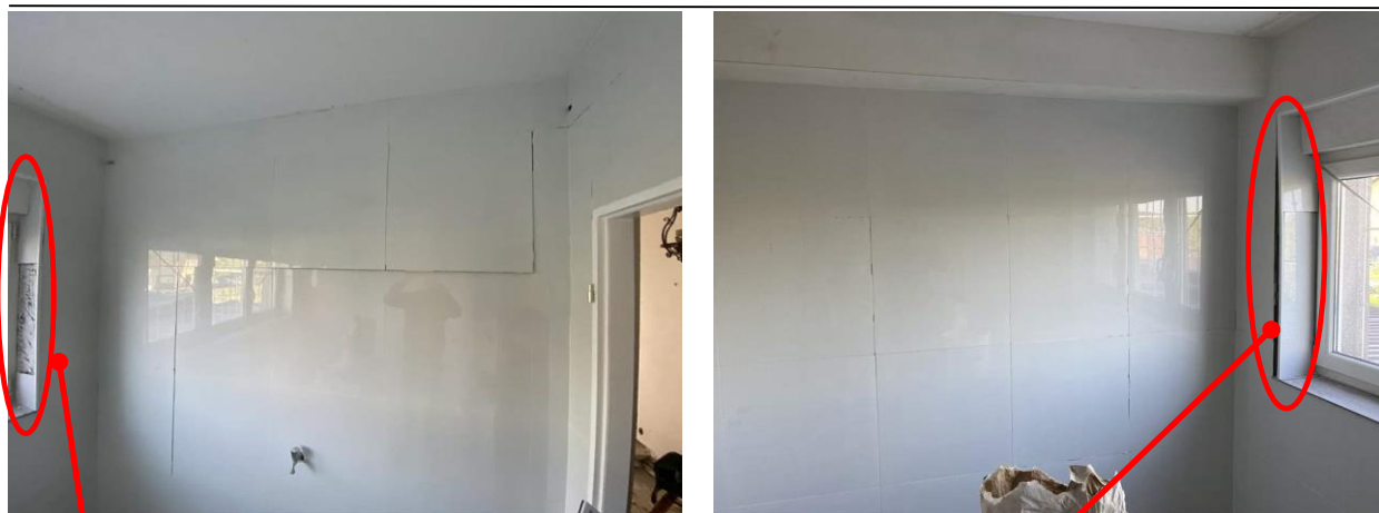
Slika 4.16. Istočni pregradni zid (lijevo), zapadni krajnji nosivi zid prema zajedničkom stubištu (desno);
