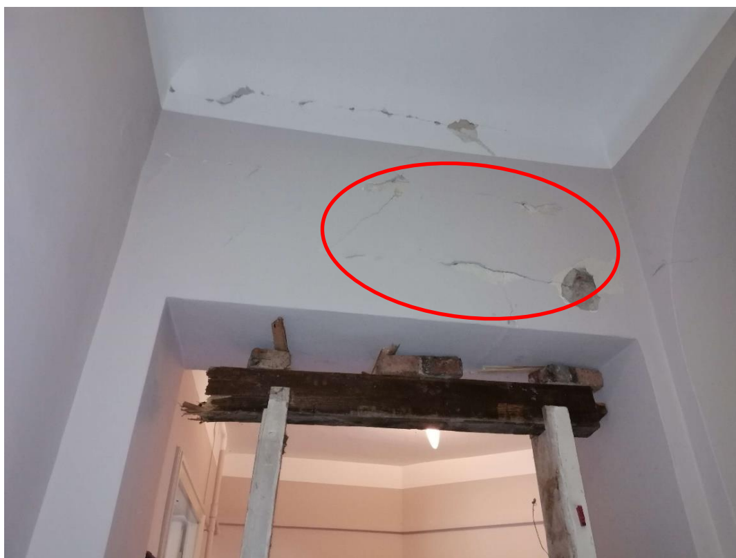
Slika 4.4. Pogled hodnikom u smjeru zapada prema oštećenom nadvoju
