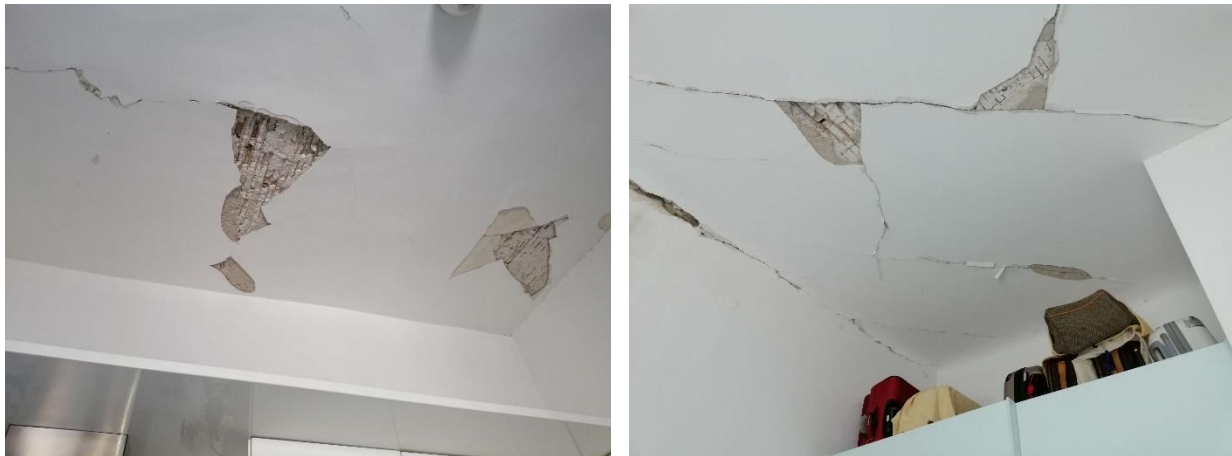
Slika 4.15. Dijagonalne pukotine po cijeloj površini stropa
