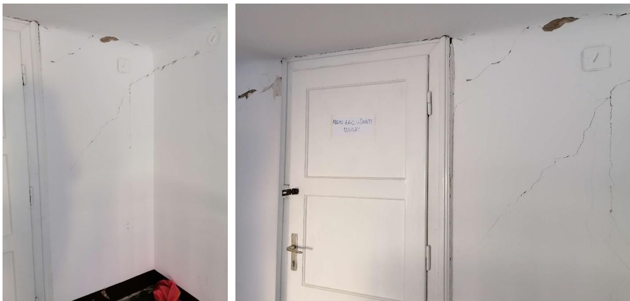
Slika 4.33. Pukotine po nosivim zidovima stubišta
