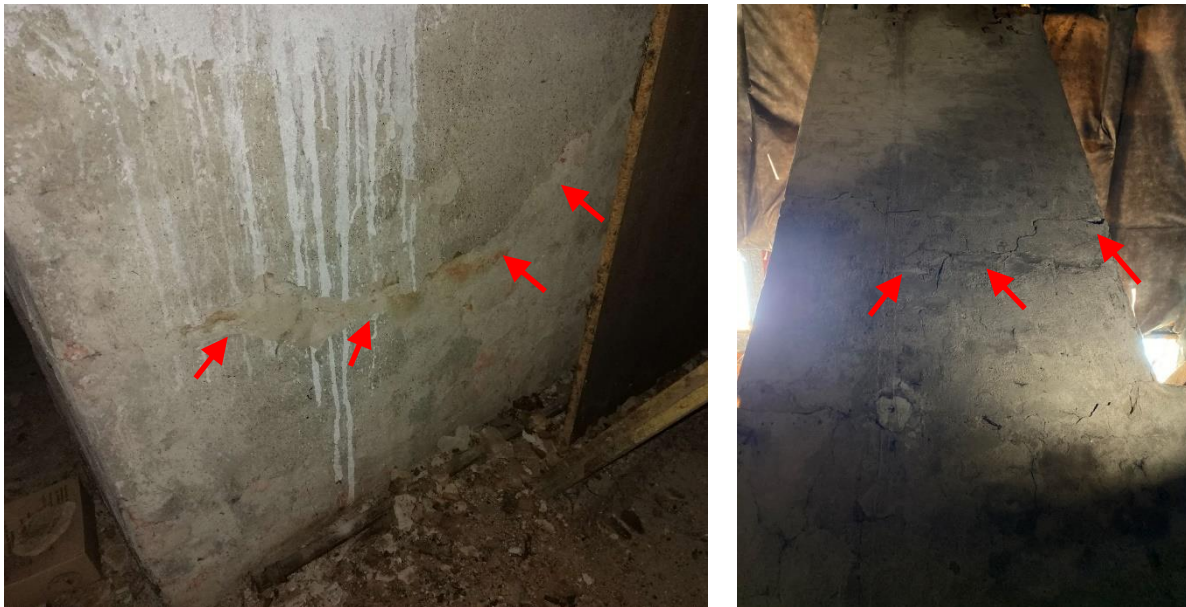
Slika 4.30. Dijagonalne i horizontalne pukotine na dimnjaku
