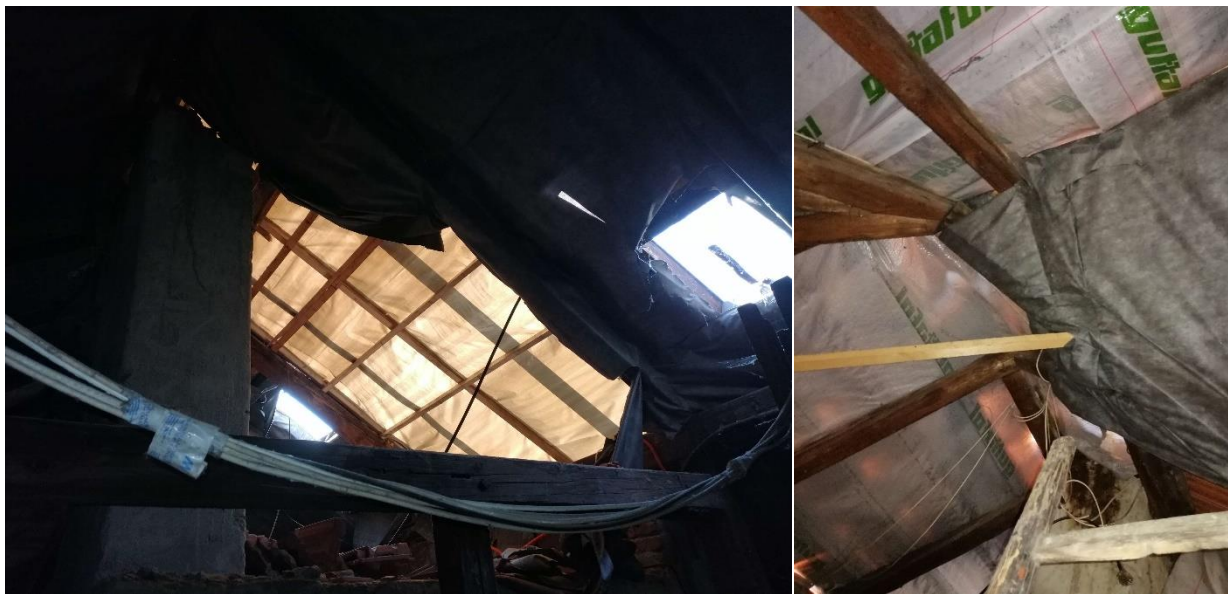
Slika 4.32. Oštećene krovne plohe, potrebna zamjena krovnog pokrova te adekvatna i stručna sanacija
