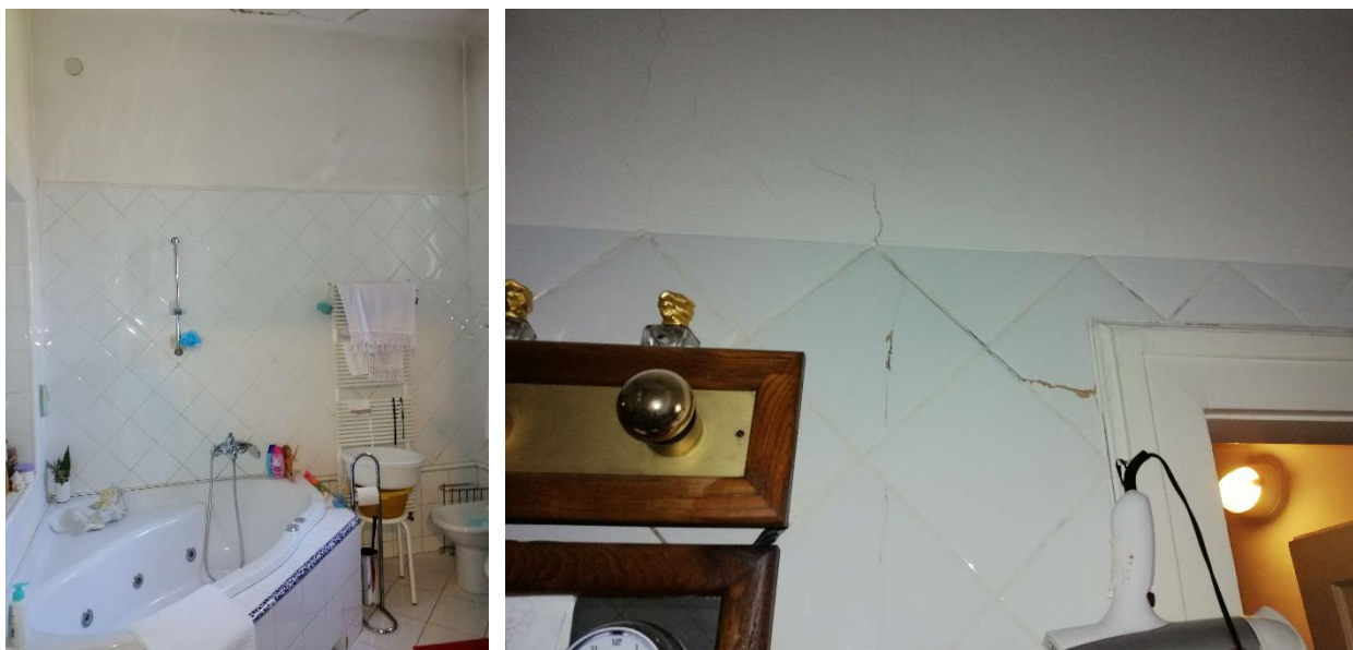
Slika 4.22. Pukotinska oštećenja u kupaonici
