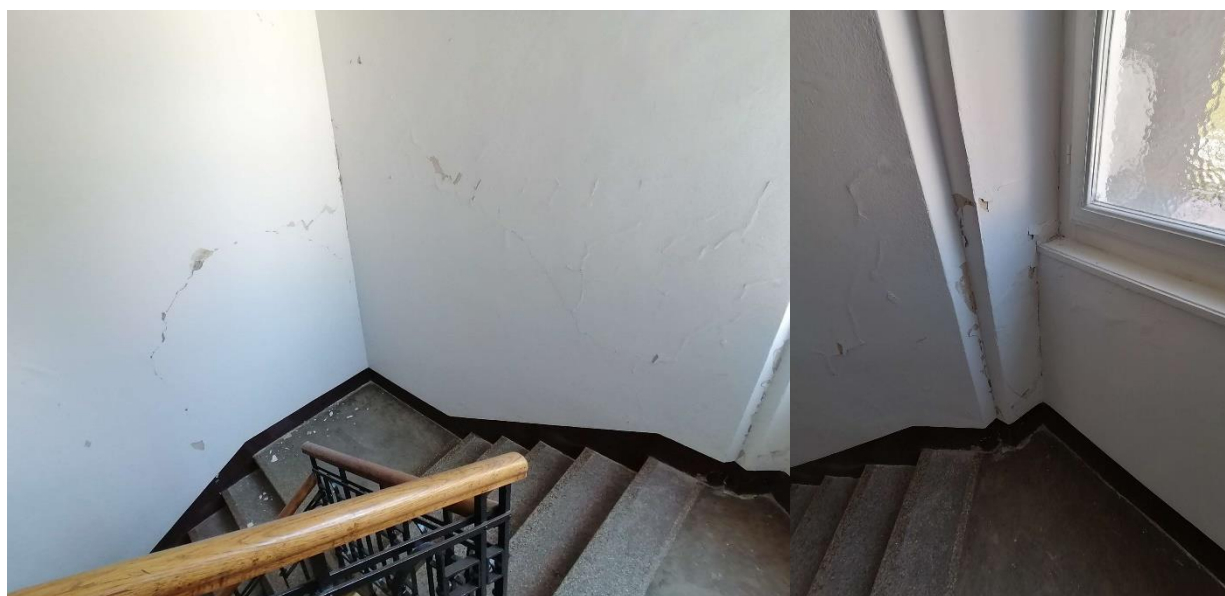
Slika 4.37. Površinska oštećenja na nosivim zidovima stubišnog prostora
