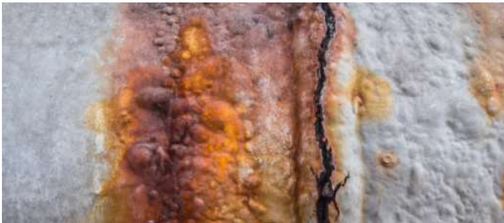
Slika 6 - Prikaz posljedice napetosne korozije
