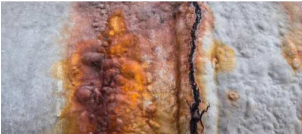
Slika 6 - Prikaz posljedice napetosne korozije
