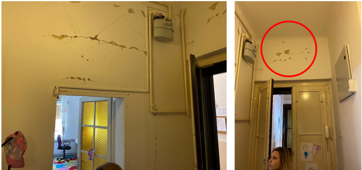
Slika 19. Pukotina nadvoja lijevo i desno duboka pukotina nosivog zida prema stubištu.
