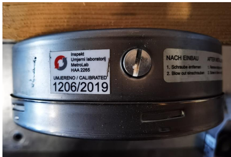
Slika 10. Kontrolna oprema – naljepnica o umjeravanju
