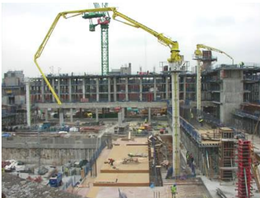
Slika 5.1 Sustav za transport betona [19]
