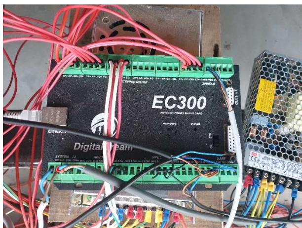
Slika 4.3 Probno spajanje CNC kontrolera
