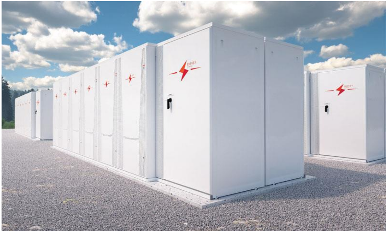
Slika 4.1 Postrojenje baterijskih spremnika [30]
