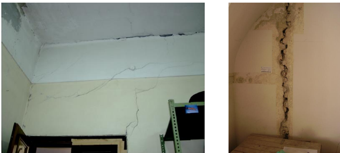
Slika 3.5 Pukotine na zidovima međukata
