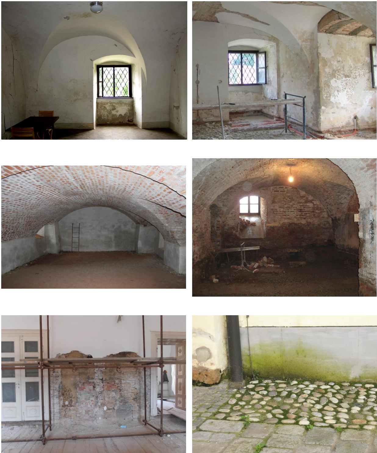
Slika 3.25 Fotodokumentacija oštećenja od vlage
