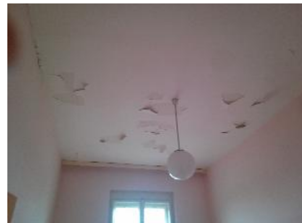
D. Otpadanje žbuke sa stropova
