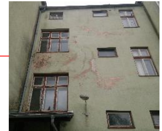
Razorno djelovanje vlage na vanjsku ovojnicu zgrade
