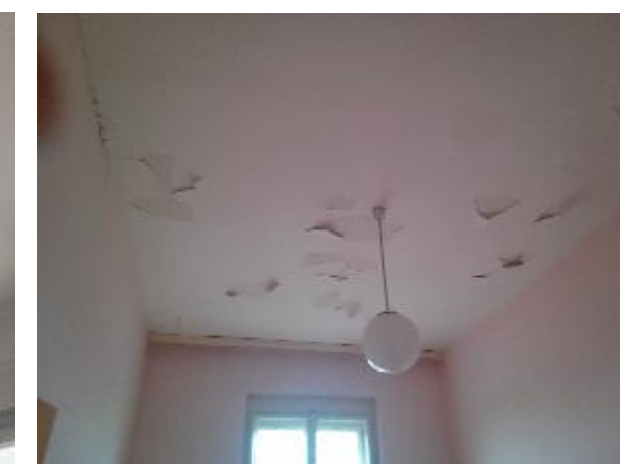
D. Otpadanje žbuke sa stropova
