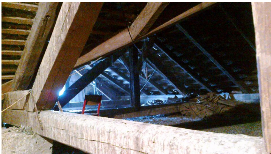
Slika 5.11 Dotrajala krovnna konstrukcija
