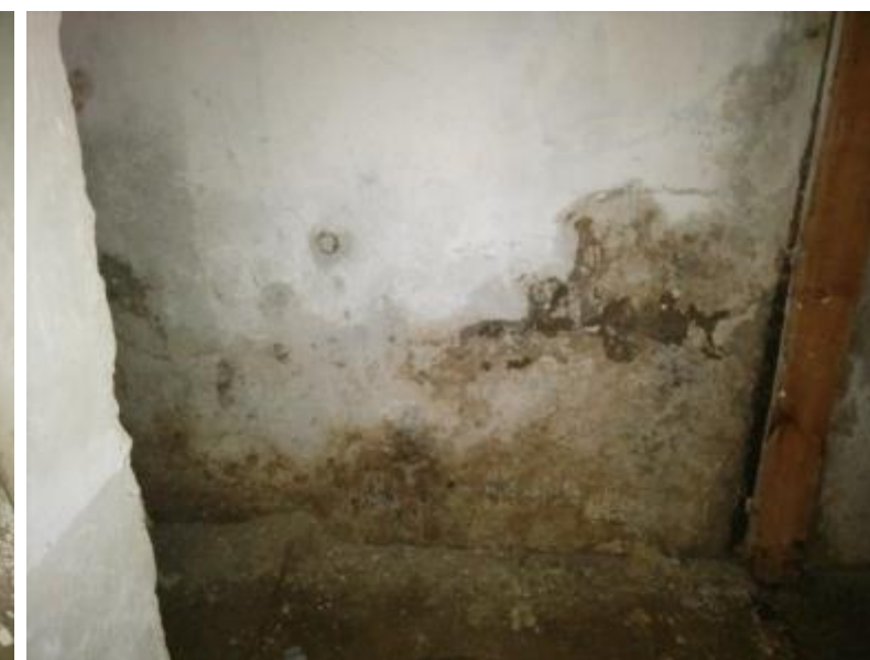
B. Kapilarna vlaga u zidovima
