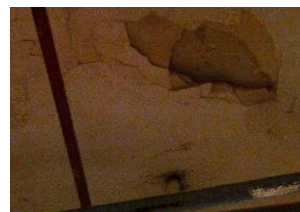
E. Otpadanje žbuke sa stropova podruma
