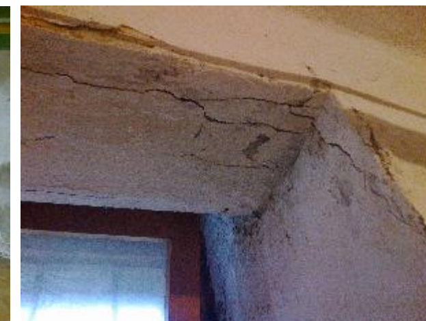
D. Sitne pukotine na nadvoju iznad prozora
