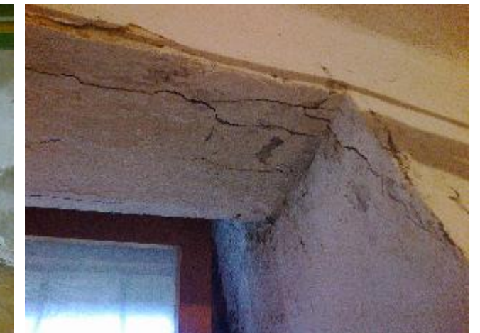
D. Sitne pukotine na nadvoju iznad prozora
