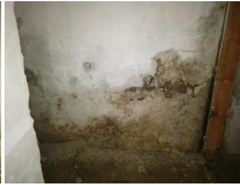
B. Kapilarna vlaga u zidovima
