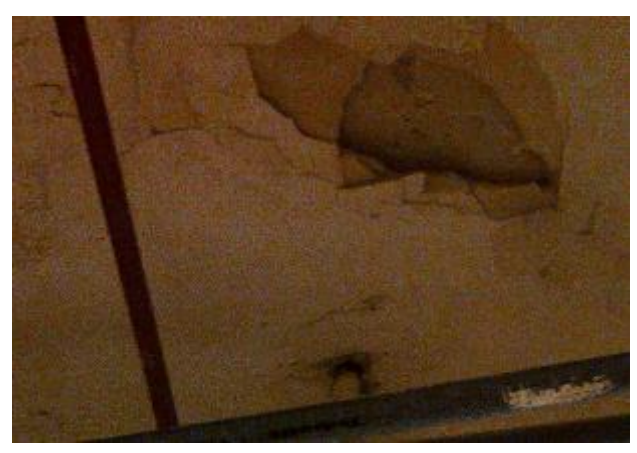
E. Otpadanje žbuke sa stropova podruma
