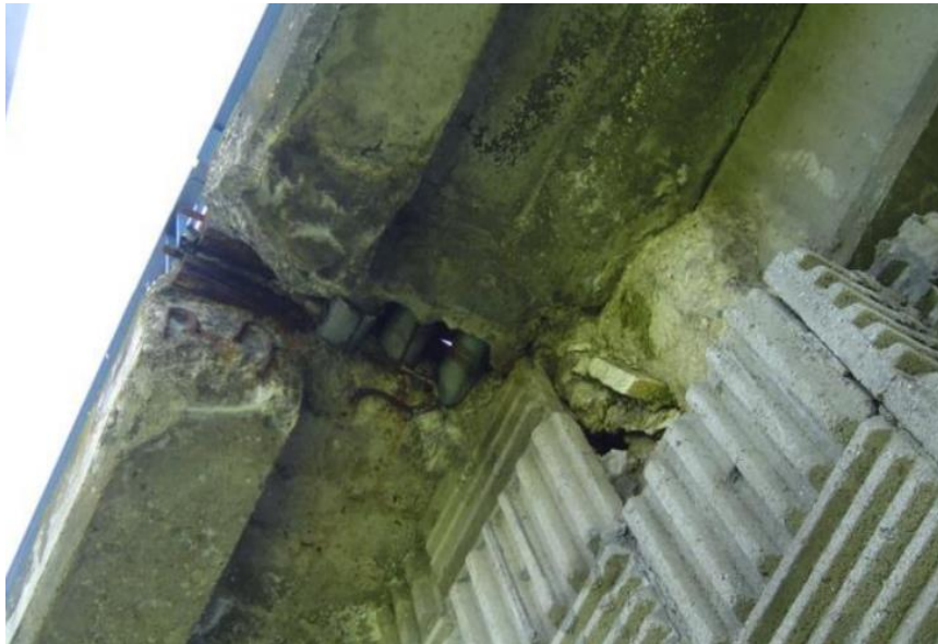
Slika 6. Detalj oštećene dilatacije na mjestu spoja nosača prvog raspona i upornjaka [20]
