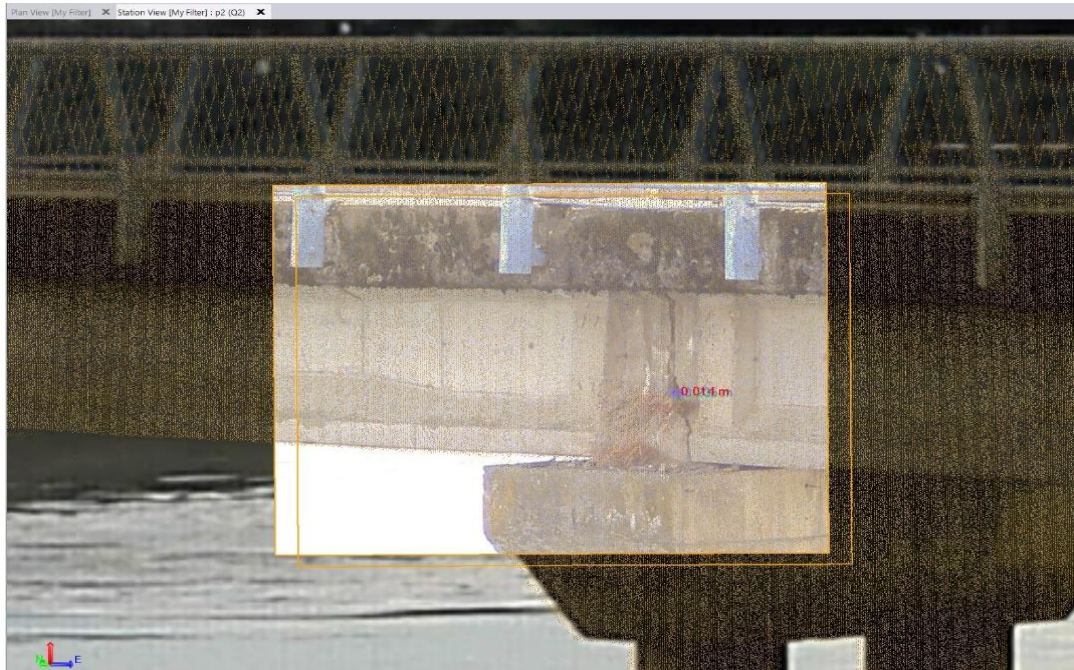
Slika 22. Mjerenje oštećenja mosta sa stajališta 2
