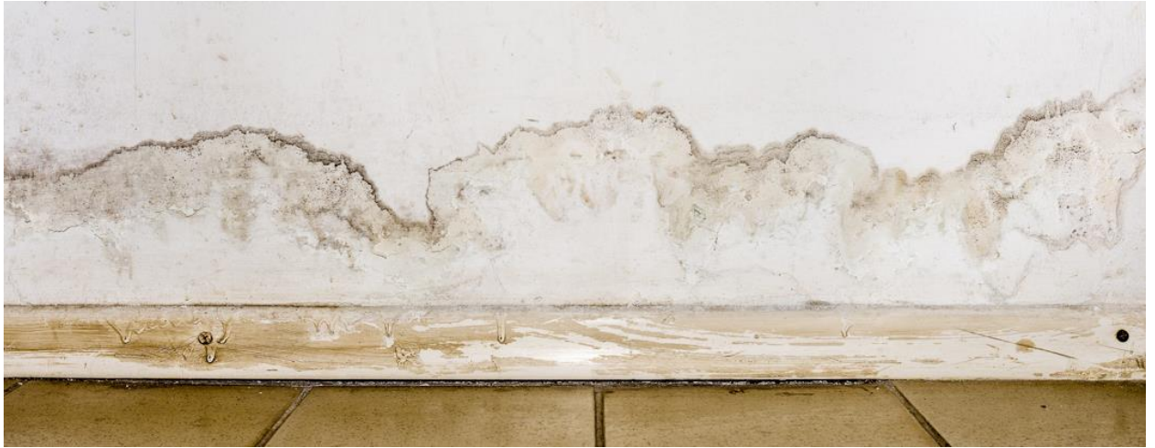
Slika 2.3. Utjecaj vlage na unutrašnji zid
