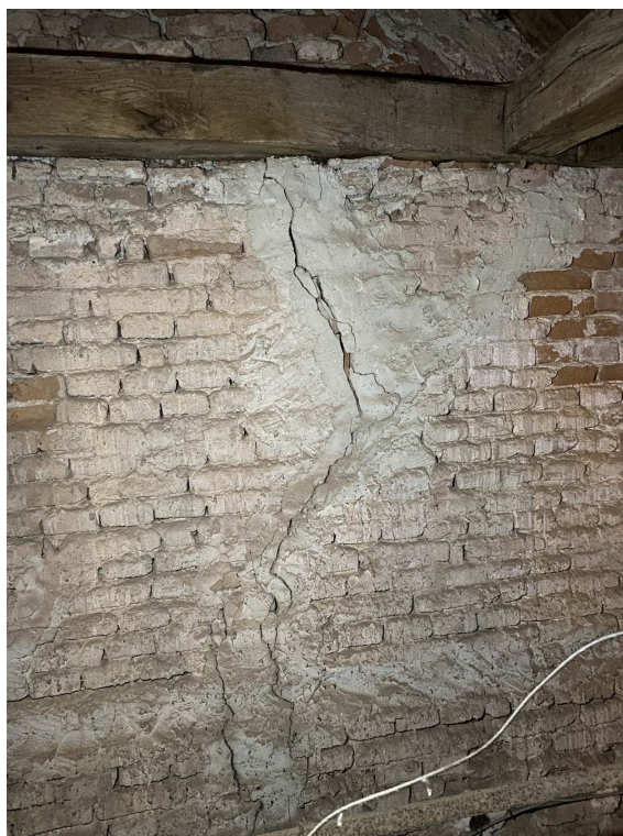
Slika 6.39. Vertikalna pukotina uz sjeverni zvonik crkve, K7
