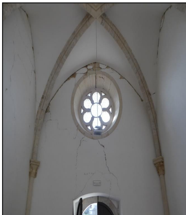
Slika 115. Unutarnja slika oštećenja zapadnog zida
