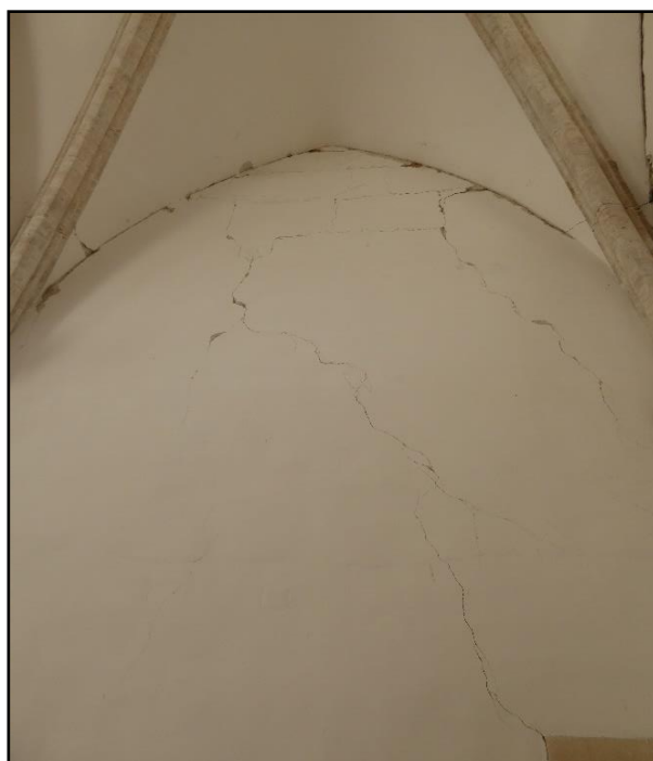
Slika 116. Pukotine na zidu crkve
