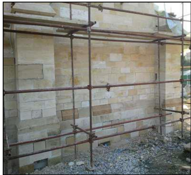
Slika 54. Detalj oštećenja kamena plivita (2)
