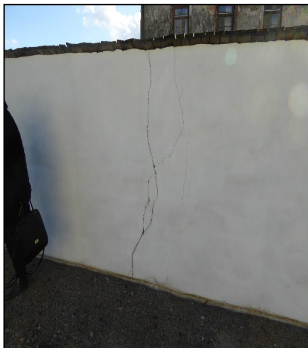
Slika 114. Pukotine na južnom zidu cinktora
