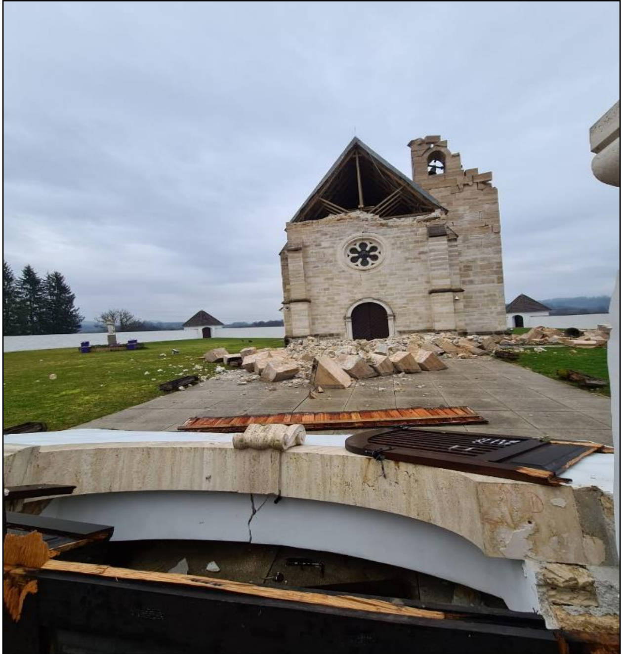
Slika 108. Razrušena crkva nakon potresa
