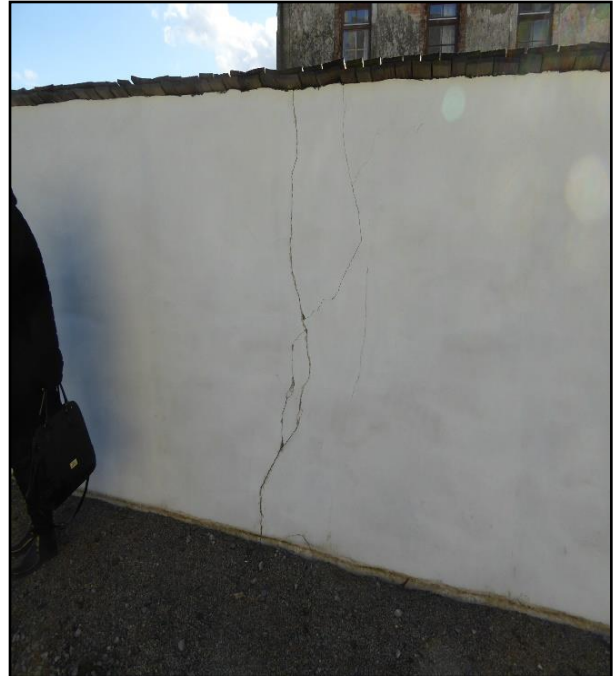
Slika 114. Pukotine na južnom zidu cinktora
