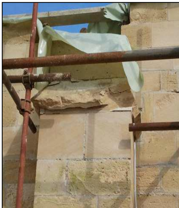
Slika 50. Detalj oštećenja lokalnog kamena (2)
