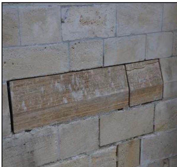
Slika 53. Detalj oštećenja kamena plivita (1)
