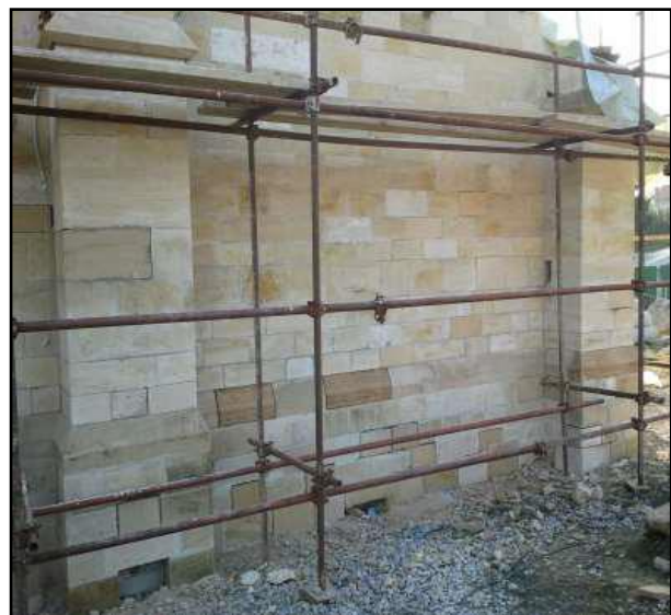
Slika 54. Detalj oštećenja kamena plivita (2)
