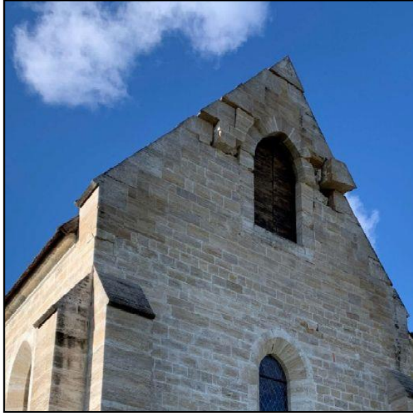
Slika 109. Oštećenje istočnog zida
