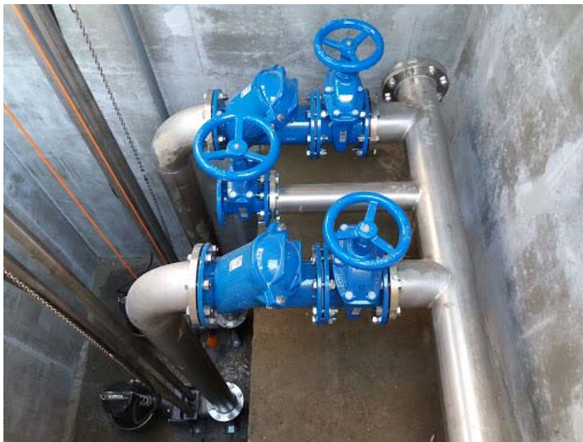
Slika 4.4. Primjer crpne stanice sa crpkama [20]
