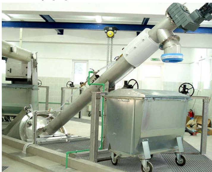
Slika 4.3. Primjer automatske fine rešetke [19]
