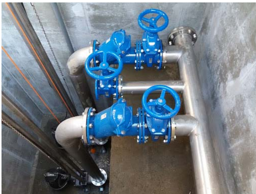
Slika 4.4. Primjer crpne stanice sa crpkama [20]
