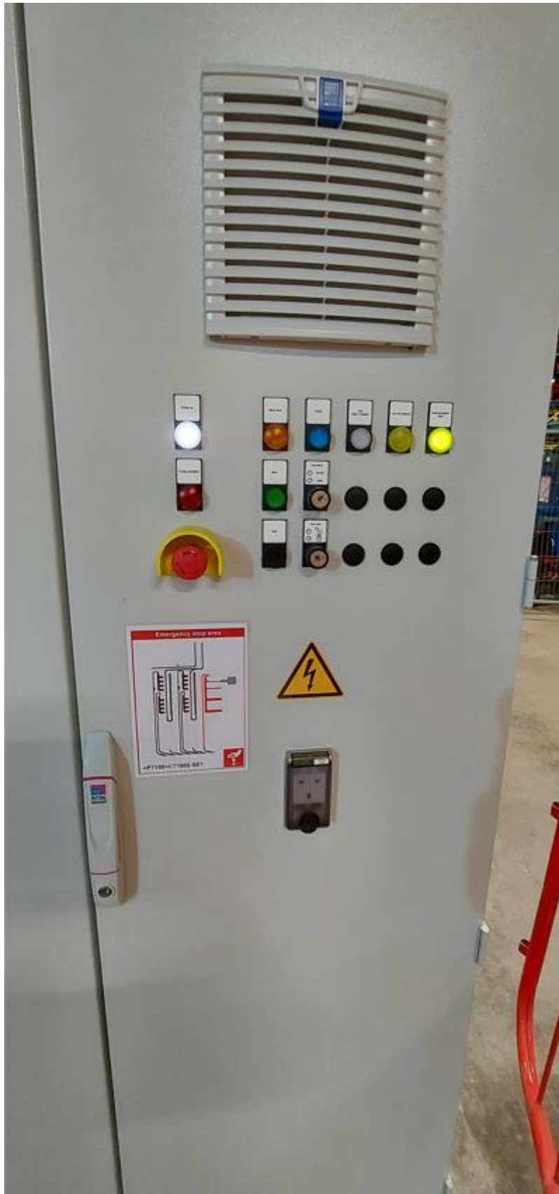
Slika 6.19 Izgled ormara izvana
