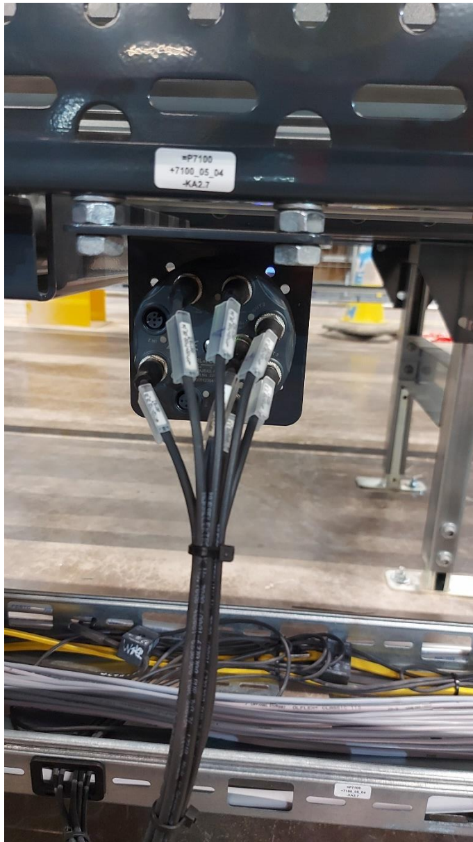
Slika 8.1 Primjer oznaka na kablama, te na kanalu i transportnom kanalu
