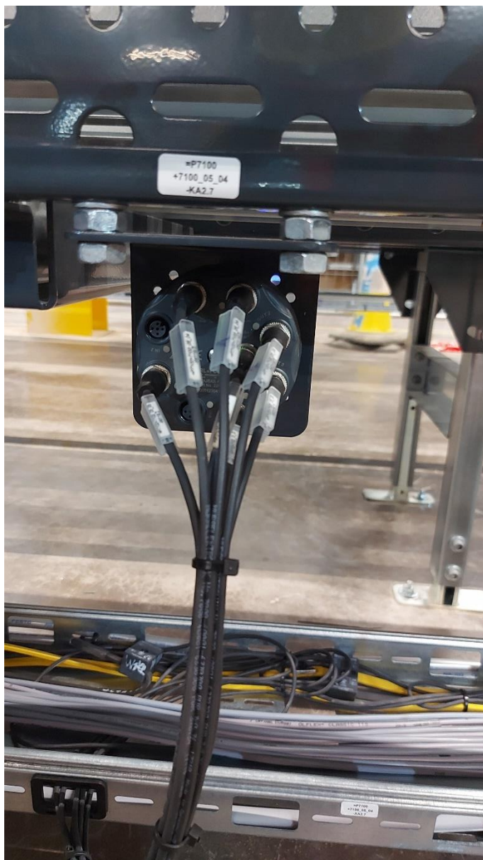
Slika 8.1 Primjer oznaka na kabelima, te na kanalu i transportnom kanalu
