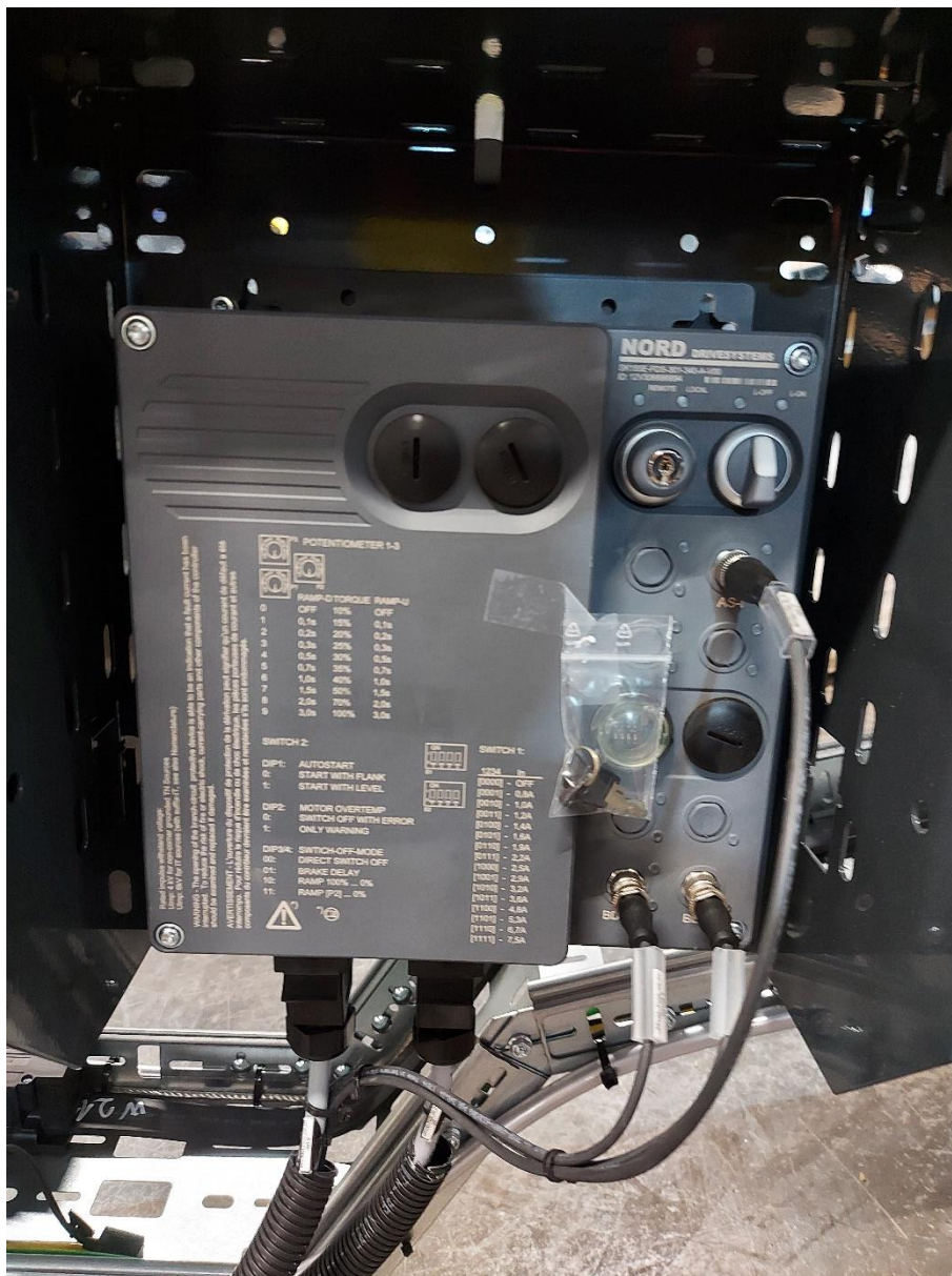
Slika 7.3 Lokalni motorni pokretač koji se koristi u našem postrojenju
