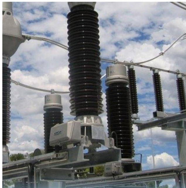
Slika 2.13 Mjerni transformator 110 kV [5]
