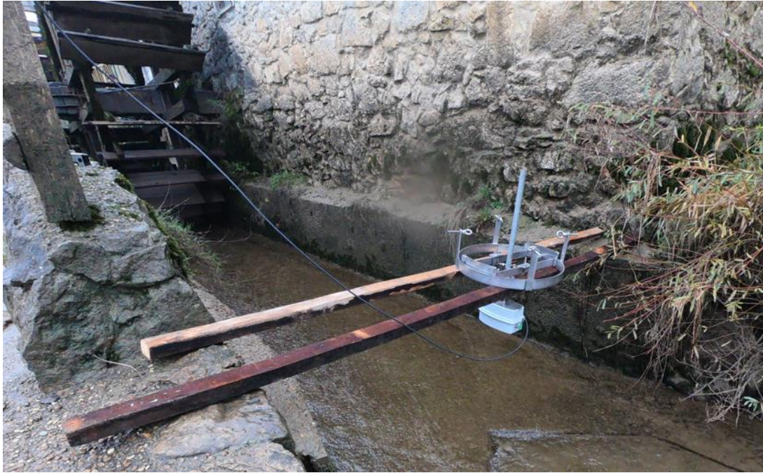
Slika 25. Prikaz montaže i mjerenja sa SQ-R Flow Meter [3]
