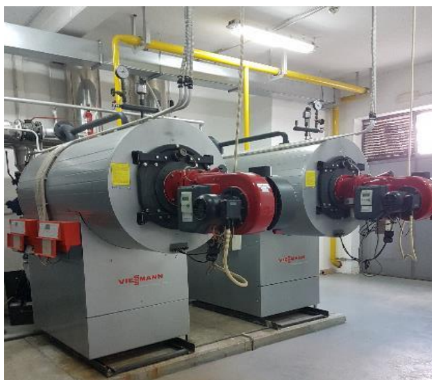
Slika 3.9 Kondenzacijski kotlovi (vlastiti izvor)
