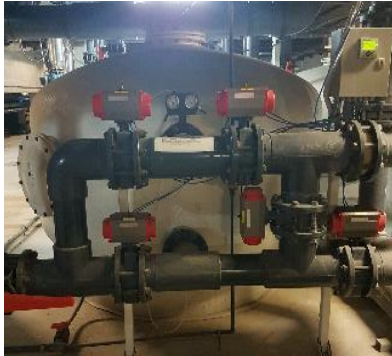
Slika 3.6 Pješčani filter s pneumatski upravljanim leptirastim ventilima i programibilnim relejom (vlastiti izvor)
