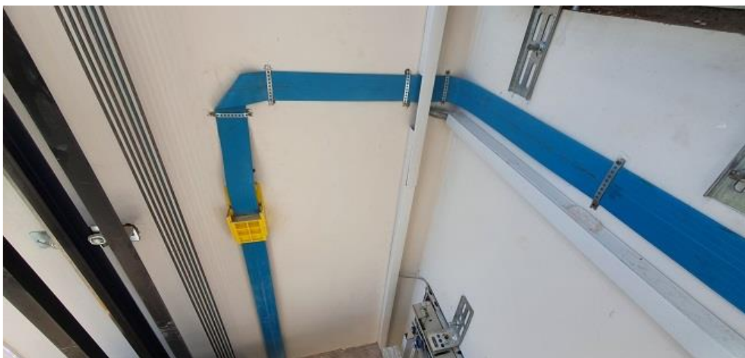
Slika 24. Električne instalacije u voznome oknu [3]
