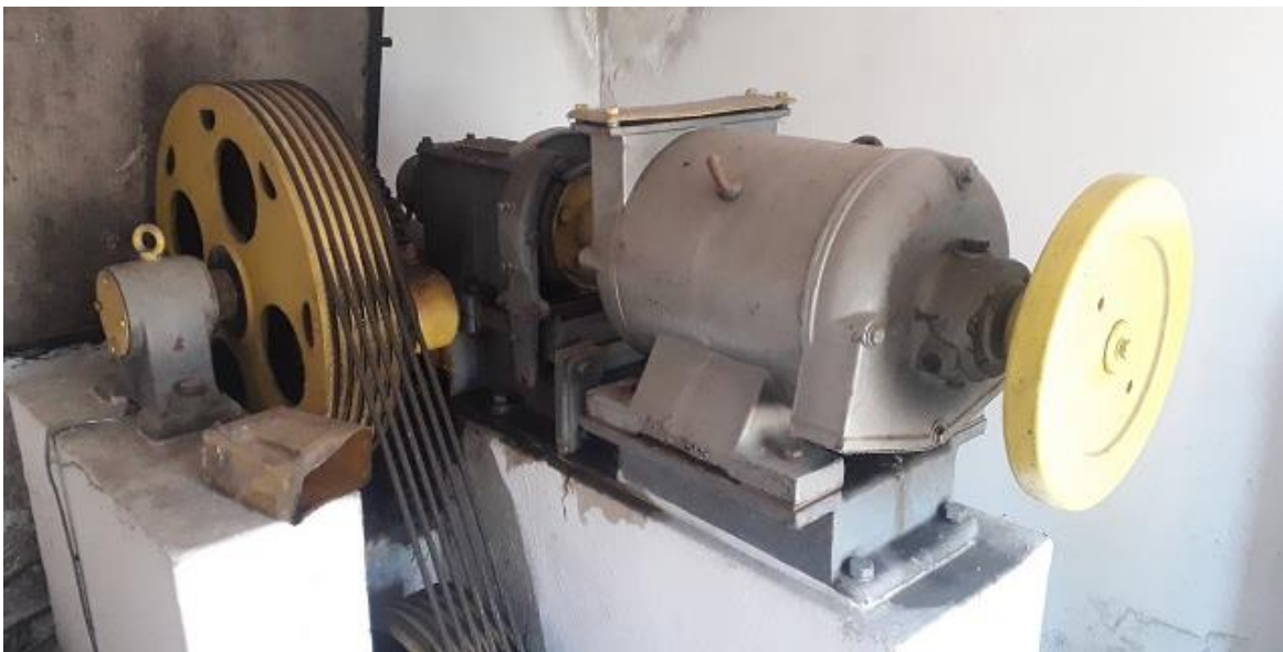
Slika 1. Elektromotor s reduktorom (skladište u Varaždinu)
