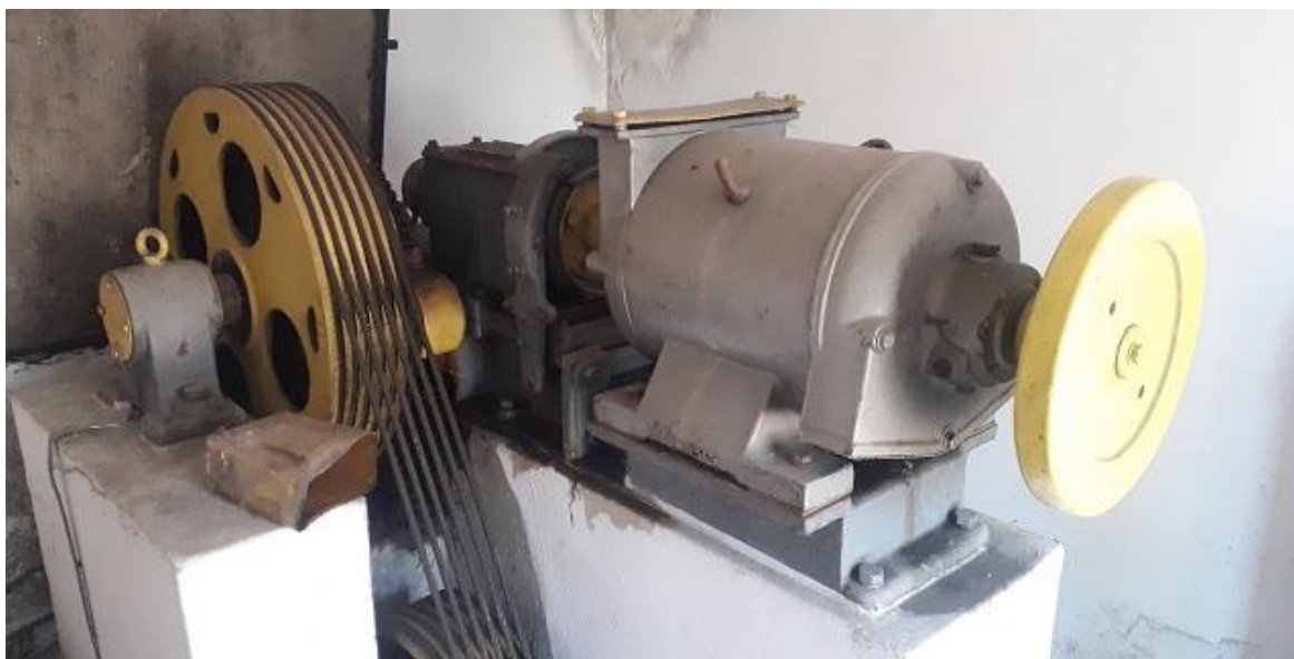
Slika 1. Elektromotor s reduktorom (skladište u Varaždinu)
