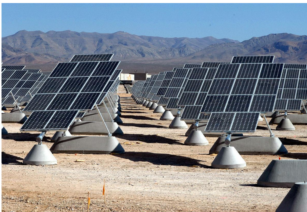
Slika 1. Primjer fotonaponske elektrane [13]
