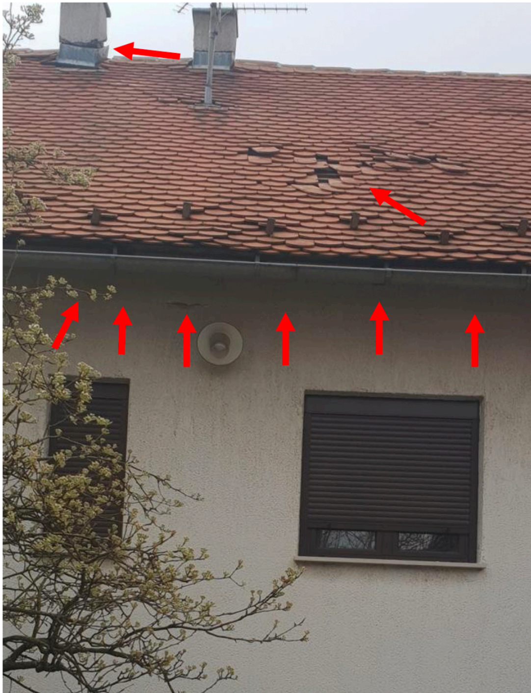
Foto 5. Pukotina vanjskog zida na poziciji MK iznad kata, oštećeni dimnjak i pokrov (S pročelje) OŠTEĆENJA TIPA 2 (MK – međukatna konstrukcija)
