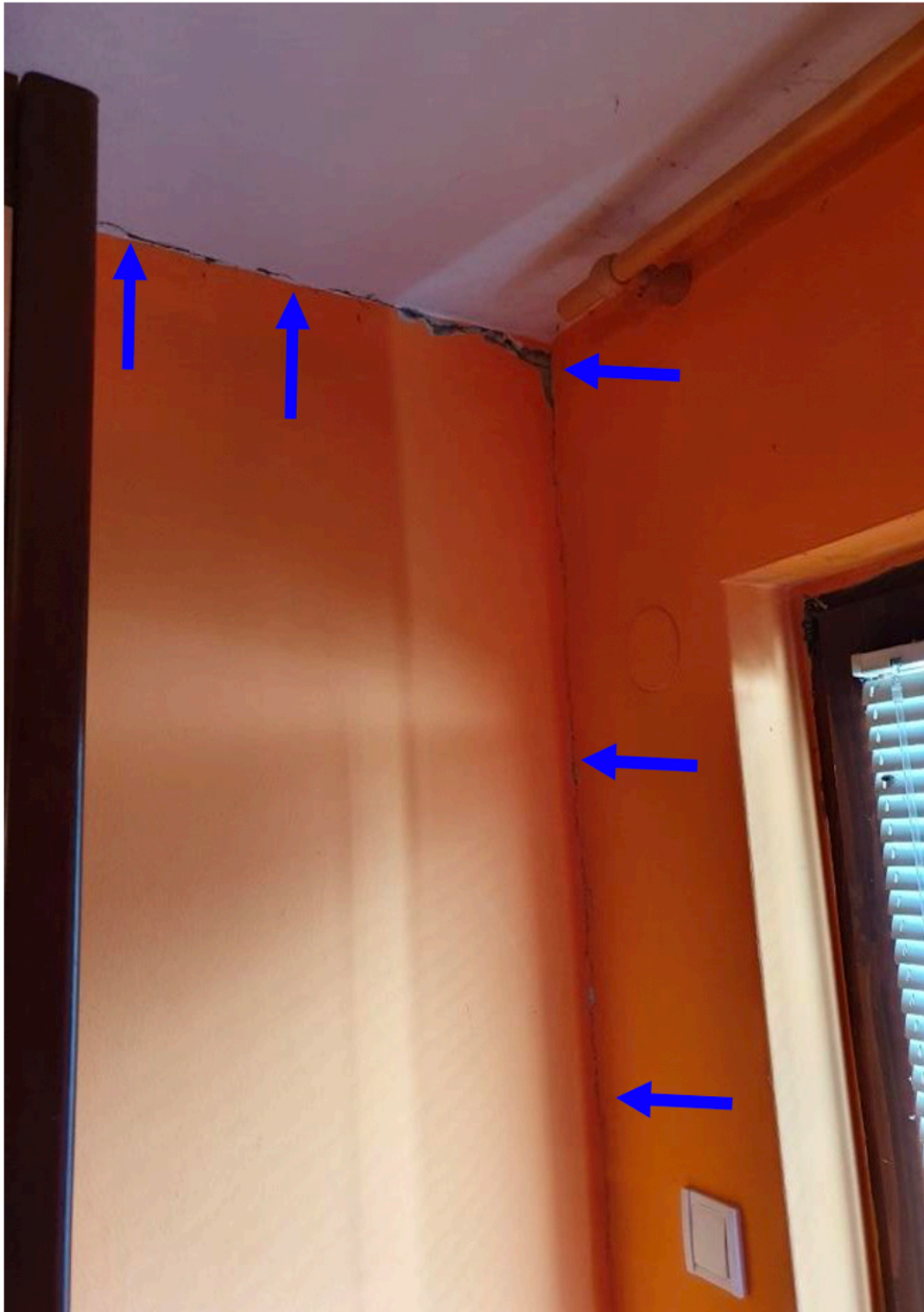
Foto 23. Pukotina na spoju unutarnjeg zida i MK kata, te unutarnjeg i vanjskog zida - OŠTEĆENJE TIP 1(MK – međukatna konstrukcija)
