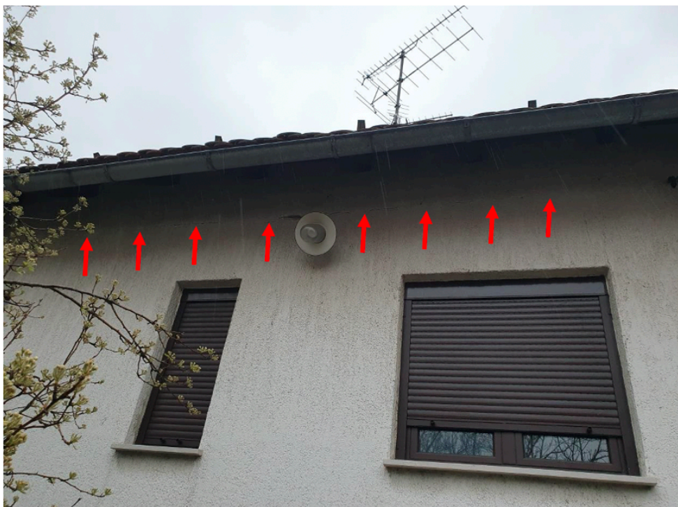
Foto 10. Pukotina u vanjskom zidu (S pročelje) – OŠTEĆENJE TIP A 2
