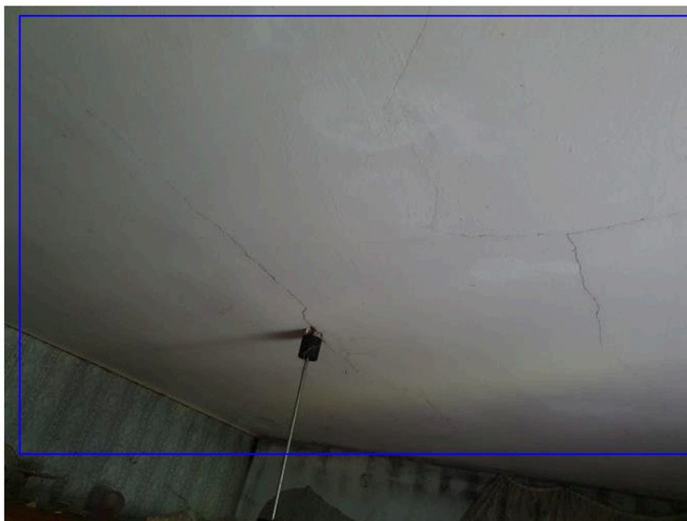
Foto 22. Pukotine podgleda stropa iznad kata OŠTEĆENJA TIP 1
