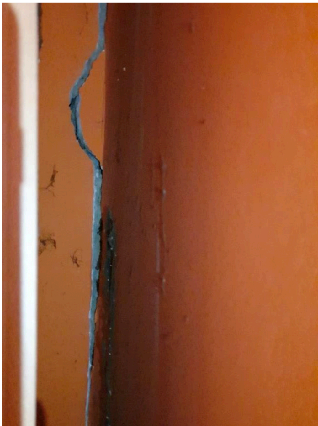
Foto 16. Vertikalna pukotina na spoju unutarnjeg i vanjskog(zida (J zid) – OŠTEĆENJE TIP 2
