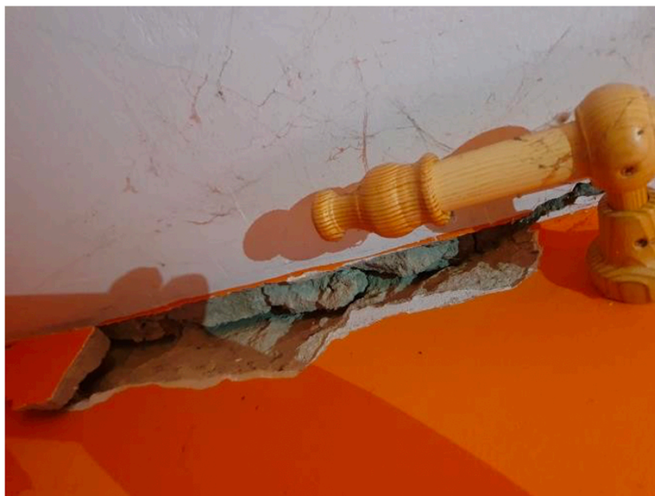
Foto 17. Horizontalna pukotina na spoju MK i vanjskog zida(J zid) - OŠTEĆENJE TIP 2 (MK – međukatna konstrukcija)
