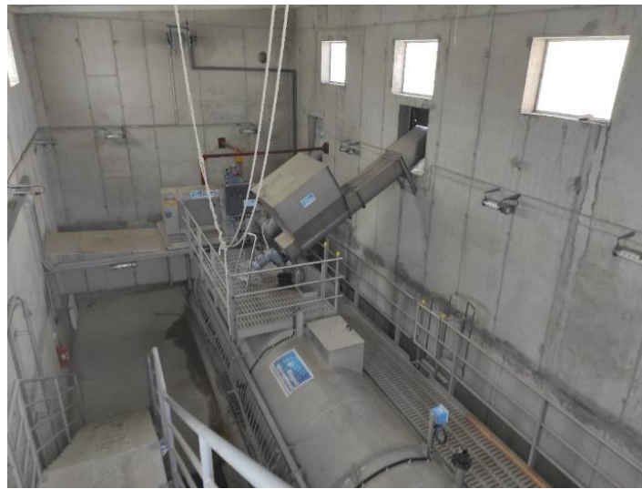
Slika 4.5. Vertikalni pjeskolov i mastolov na UPOV Koprivnica
