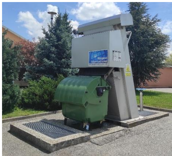
Slika 4.4. Gruba rešetka na UPOV Koprivnica
