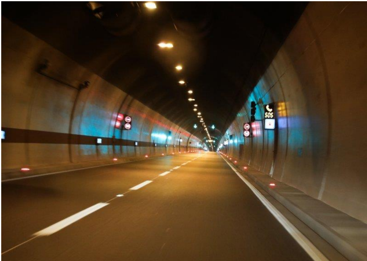
Slika 6. Rasvjetna tijela u tunelu Mravinci
