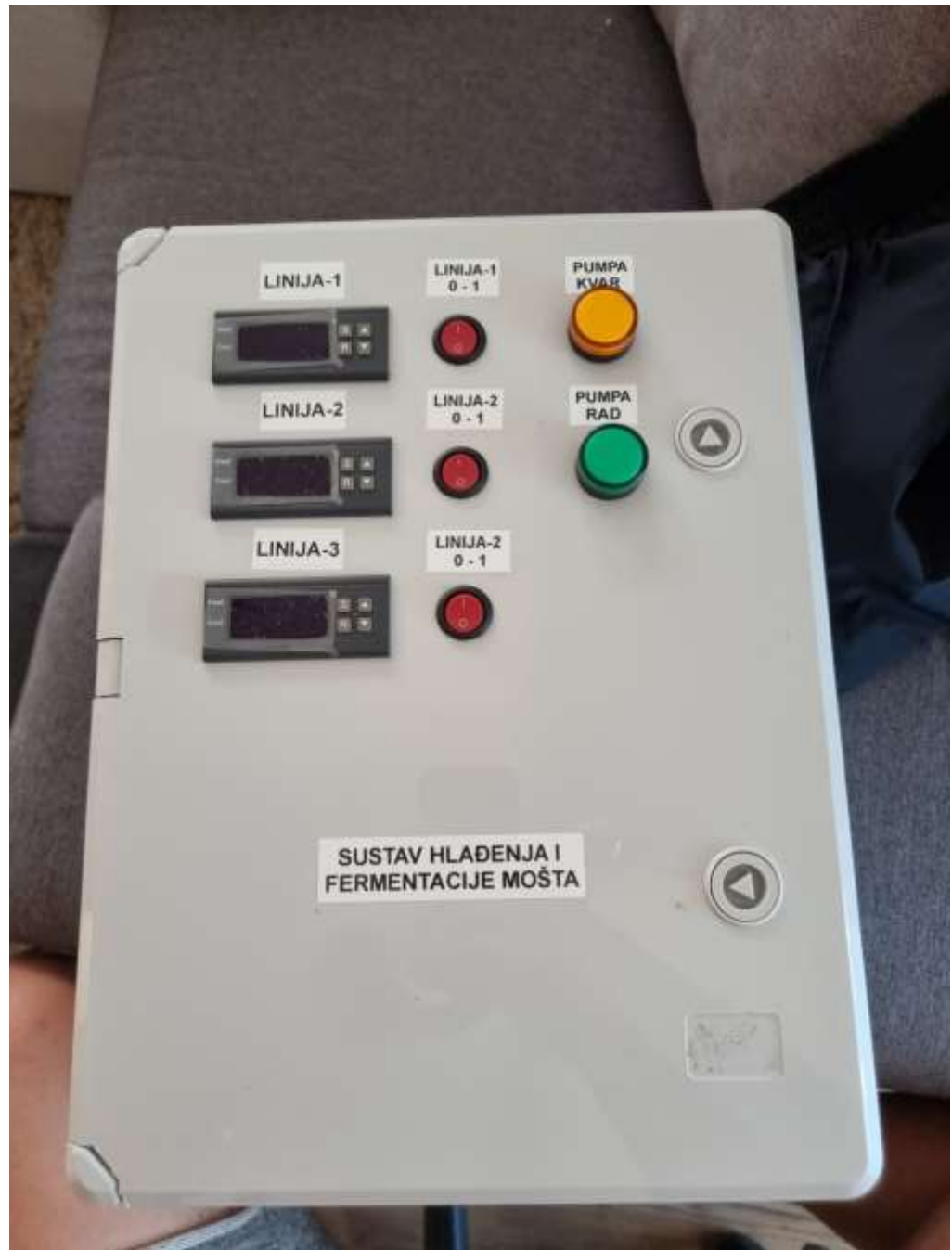
Slika 4.3. Rashladni sustav smješten u kućište
