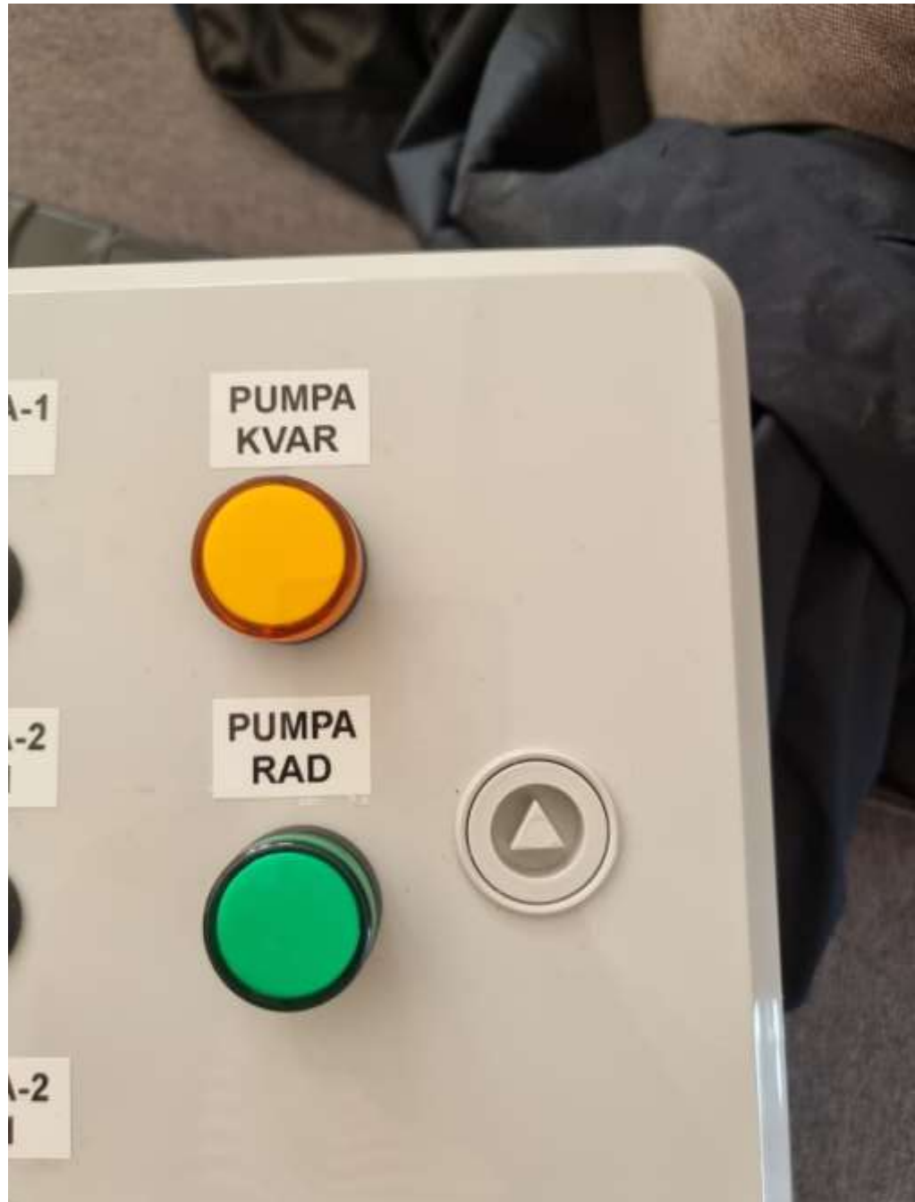
Slika 5.4. Indikatori u rashladnom sustavu
