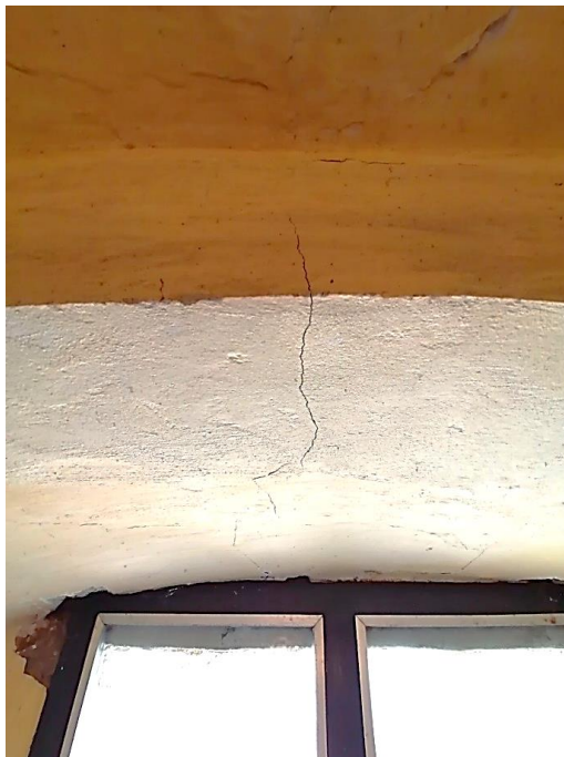
Slika 36. Pukotine nadvoja prozora nad ulazom u crkvu (zapad)
