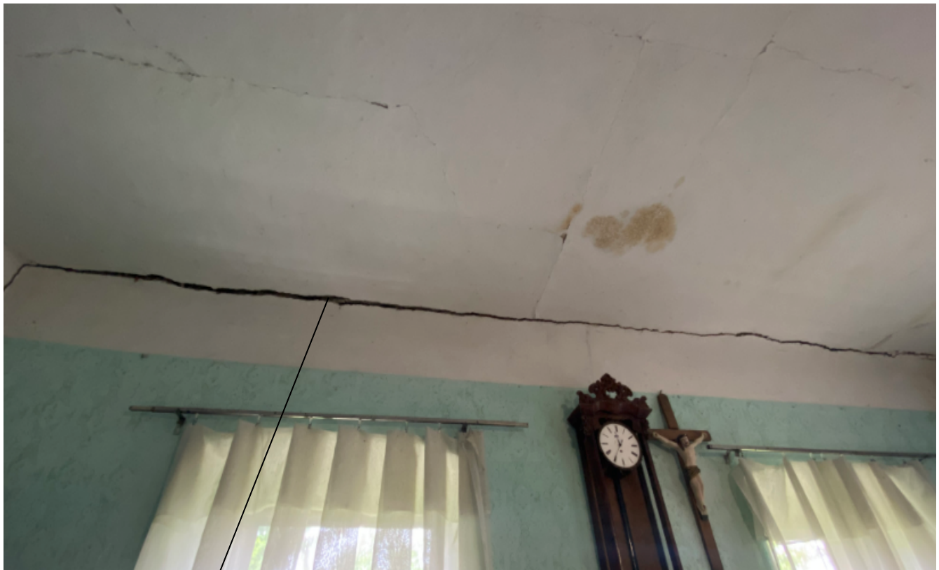
Slika 5.34. Pukotine na stropu – (oznaka na tlocrtu 4e)
