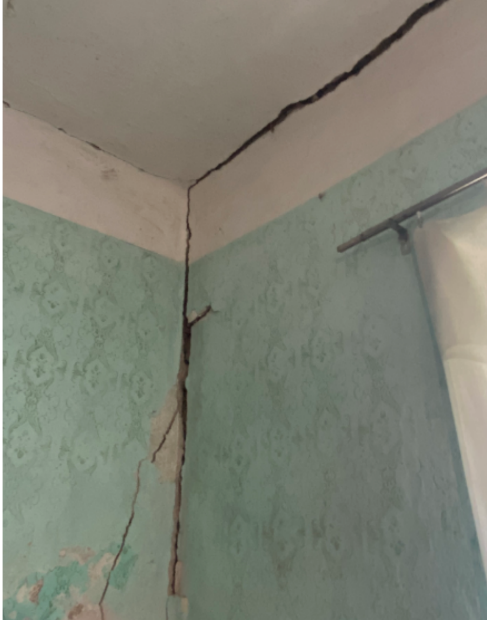
Slika 5.33. Prikaz pukotina na istočnom zidu (lijevi ugao)- (oznaka na tlocrtu 4f)
