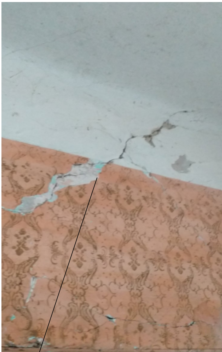
Slika 5.24. Prikaz pukotina- (oznaka na tlocrtu 1b)
