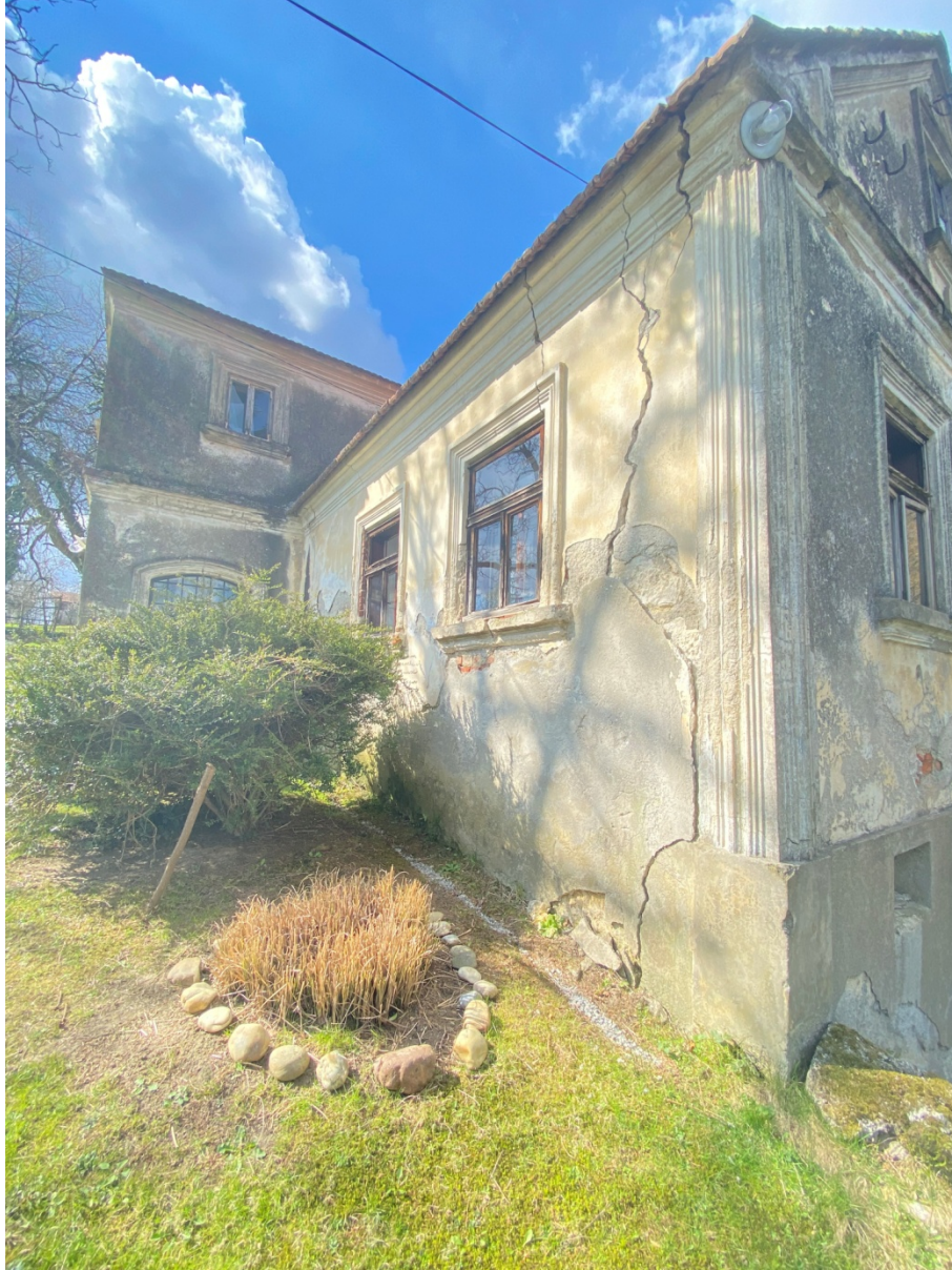
Slika 5.18. Oštećenja na južnom pročelju - (oznaka na tlocrtu 5b)
