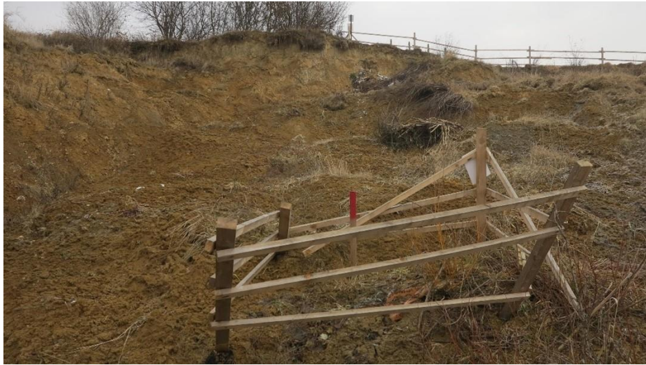
Slika 11: Razmočeno tlo gotovo je porušilo zaštitnu ogradu oko B11[1]
