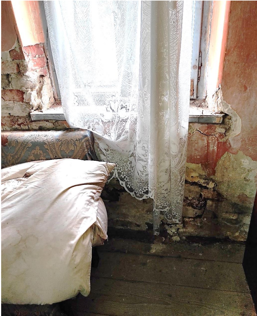
Slika 4.25 - Sjeverno pročelje sa unutarnje strane – odlamanje žbuke od zida
