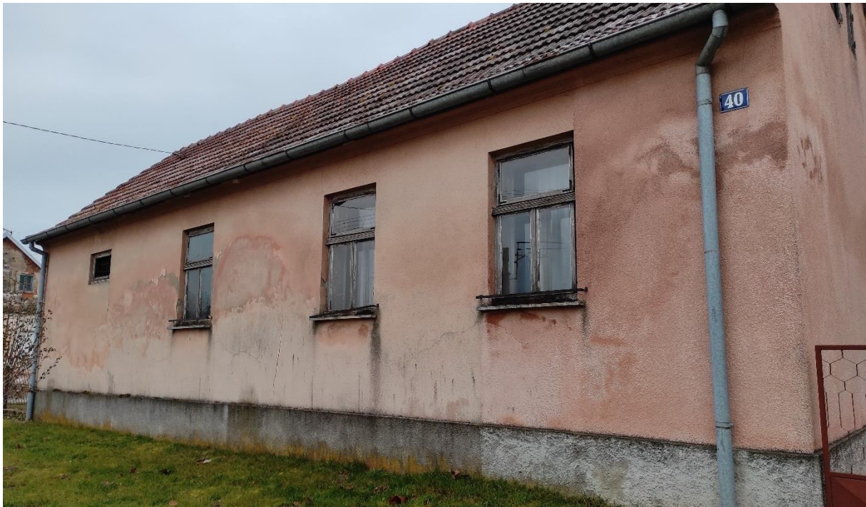
Slika 4.5 - Sjeverno pročelje - šteta od kapilarne vlage
