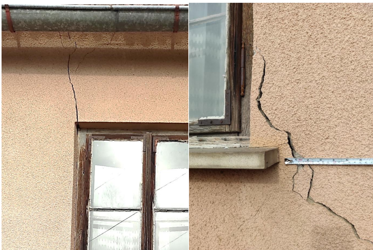
Slika 4.27 - Južno pročelje sa unutarnje strane - dubinske pukotine
