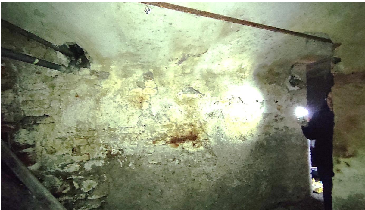
Slika 4.4 - Podrum - raslojavanje, otpadanje žbuke, plijesni na površini
