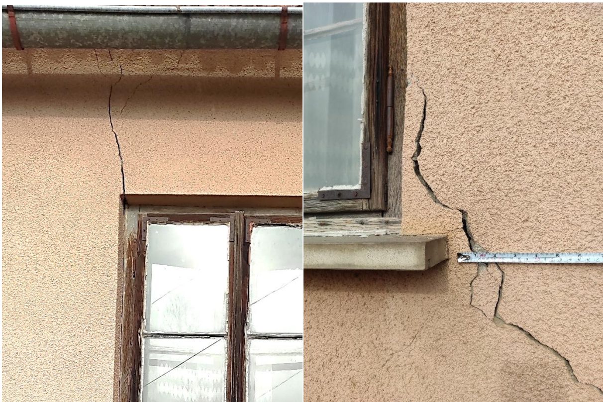
Slika 4.27 - Južno pročelje sa unutarnje strane - dubinske pukotine
