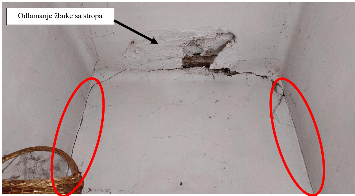
Slika 4.21 - Istočno pročelje - pukotina na spoju zida i stropa, i na spoju dvaju okomitih zidova, odlamanje žbuke stropa zbog prokišnjanja krova
