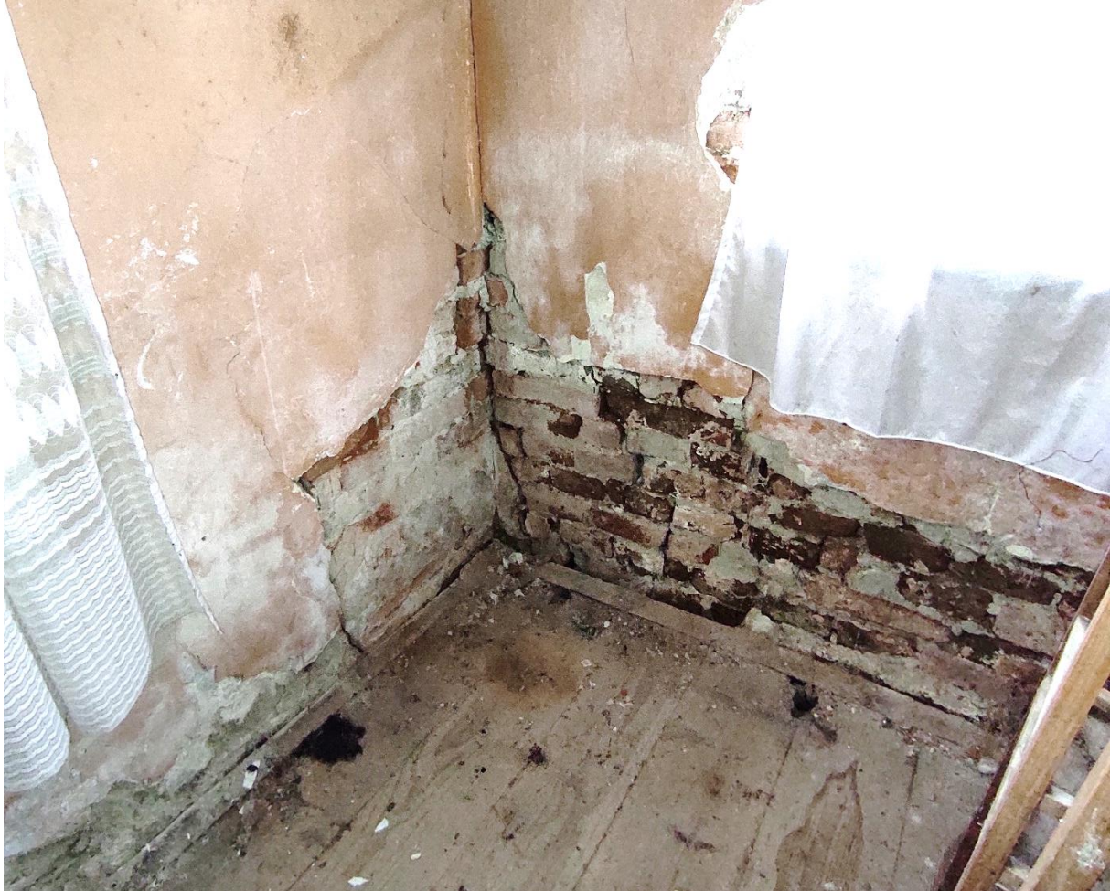
Slika 3.2 – Šteta od kapilarne vlage i soli na jugozapadnom uglu obiteljske kuće u Pušćinama
