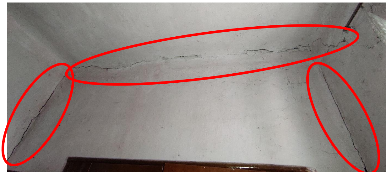
Slika 4.20 - Istočno pročelje - pukotina na spoju zida i stropa, i na spoju dvaju okomitih zidova
