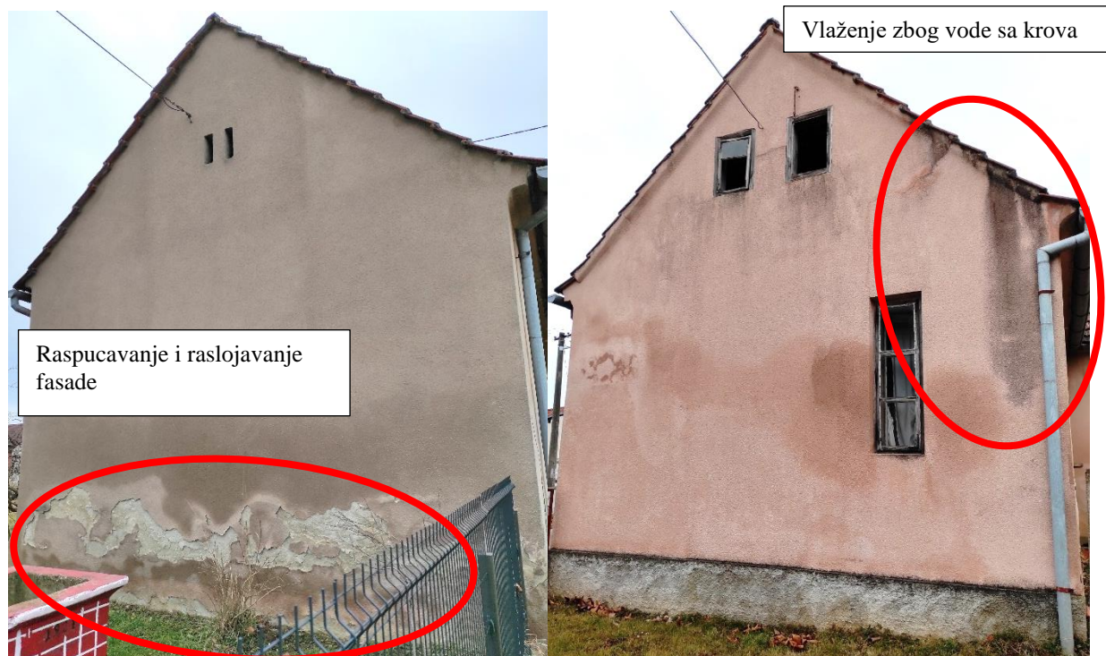
Slika 4.6 - Istočno pročelje - raspucavanje i raslojavanje fasade
