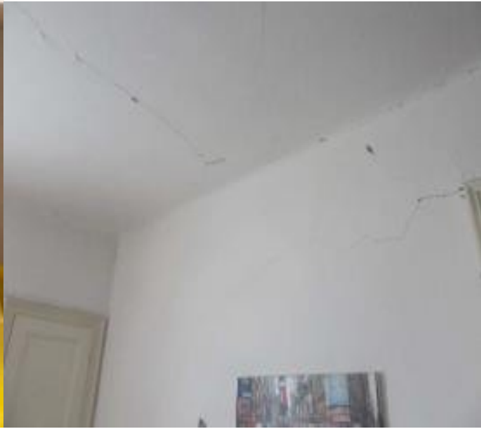
Slika 3.20. stanje pregradnih zidova 2
