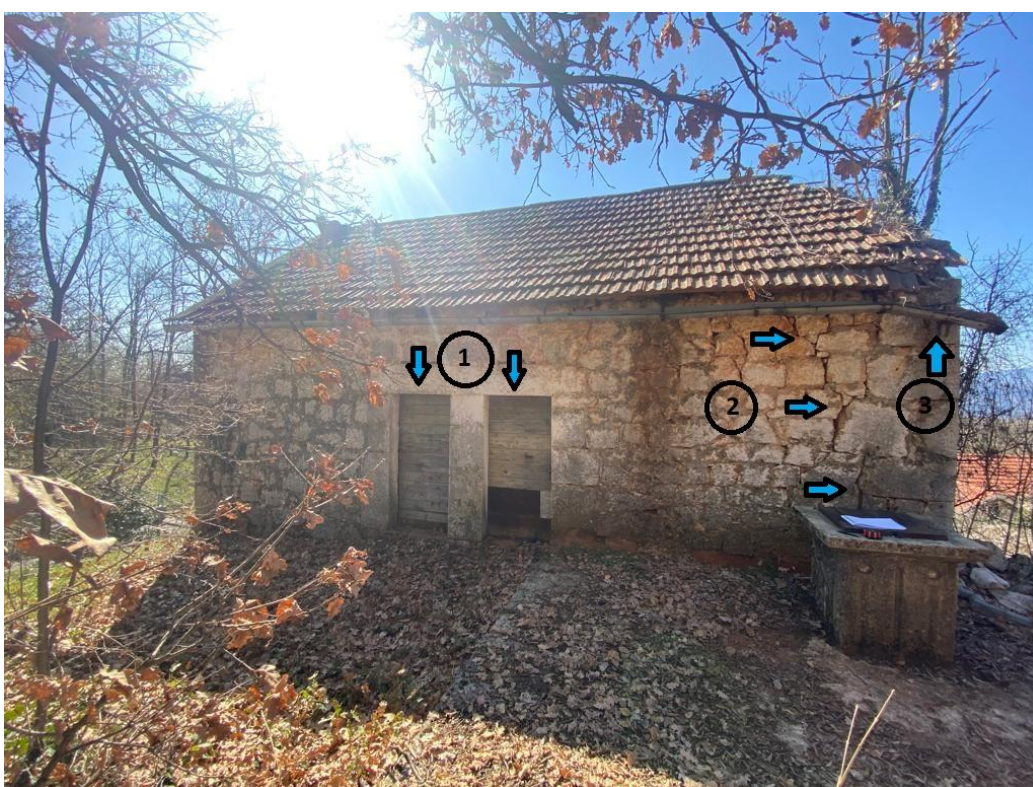
Fotografija 14: Oštećenja vanjskog zida sjeveroistočne strane [3]
