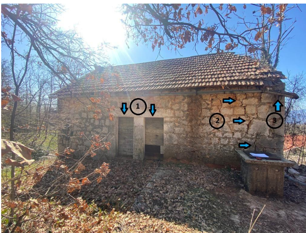
Fotografija 14: Oštećenja vanjskog zida sjeveroistočne strane [3]
