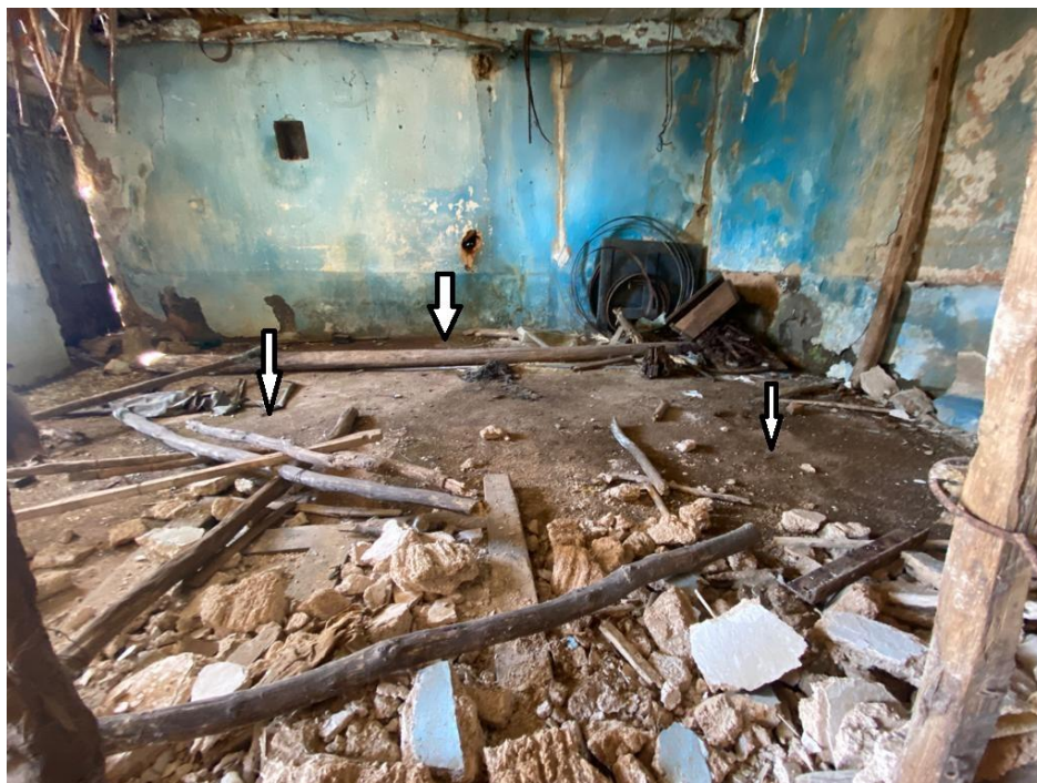
Fotografija 33: Oštećenja na podu [3]
