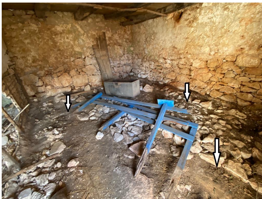
Fotografija 34: Oštećenja na podu [3]
