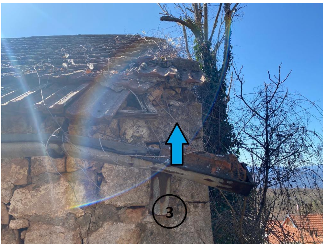
Fotografija 16: Oštećenja vanjskog zida sjeveroistočne strane - DETALJ [3]
