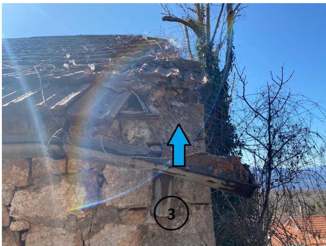
Fotografija 16: Oštećenja vanjskog zida sjeveroistočne strane - DETALJ [3]
