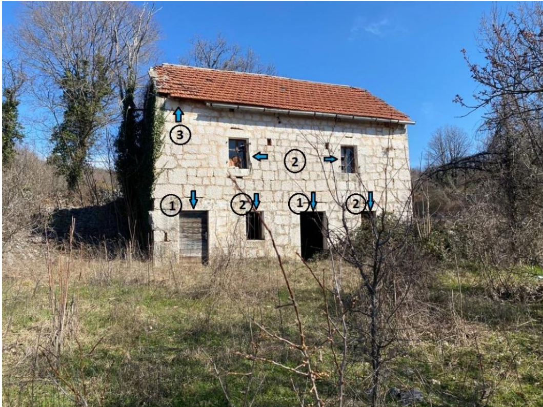
Fotografija 12: Oštećenja - jugozapad – označena sa brojevima [3]
