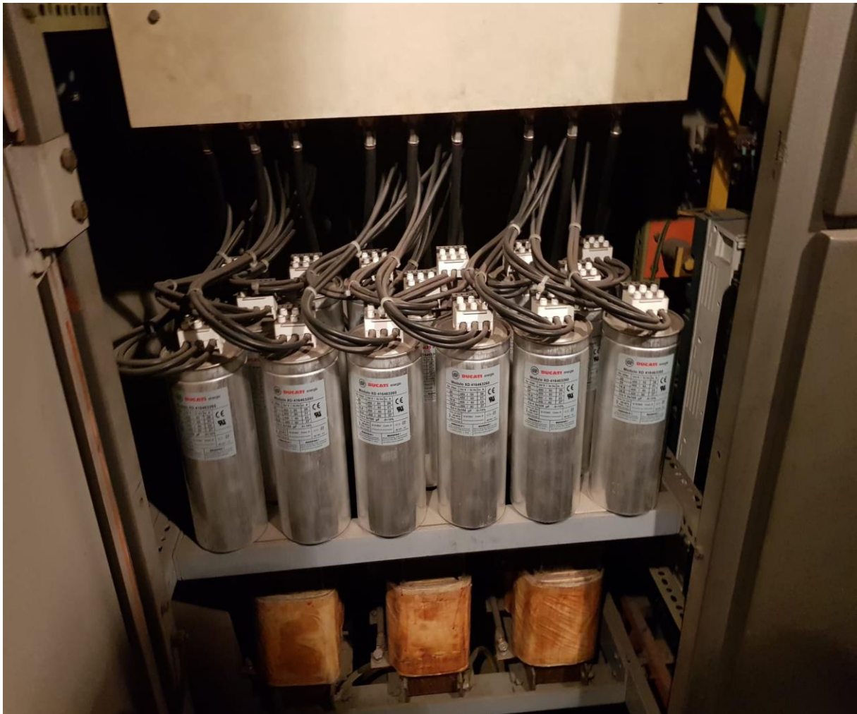
Slika 24. Trofazne kompenzacijske baterije unutar kompenzacijskog ormara
