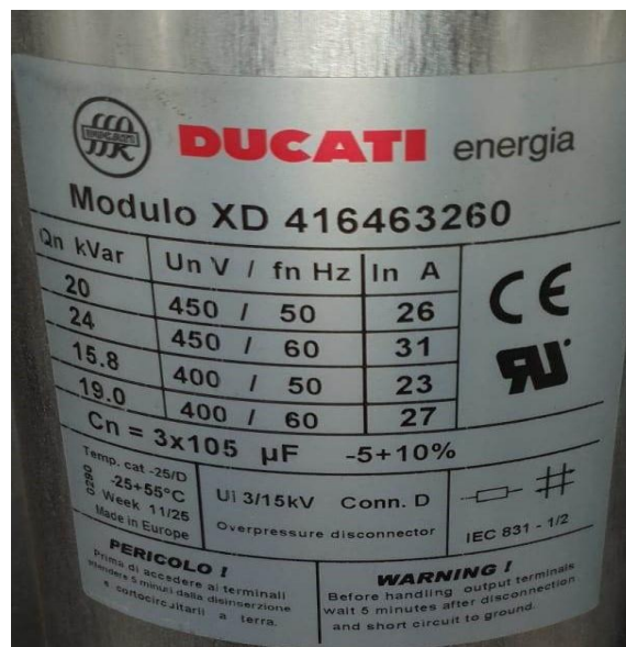
Slika 25. Nazivni podaci kondenzatorske baterije
