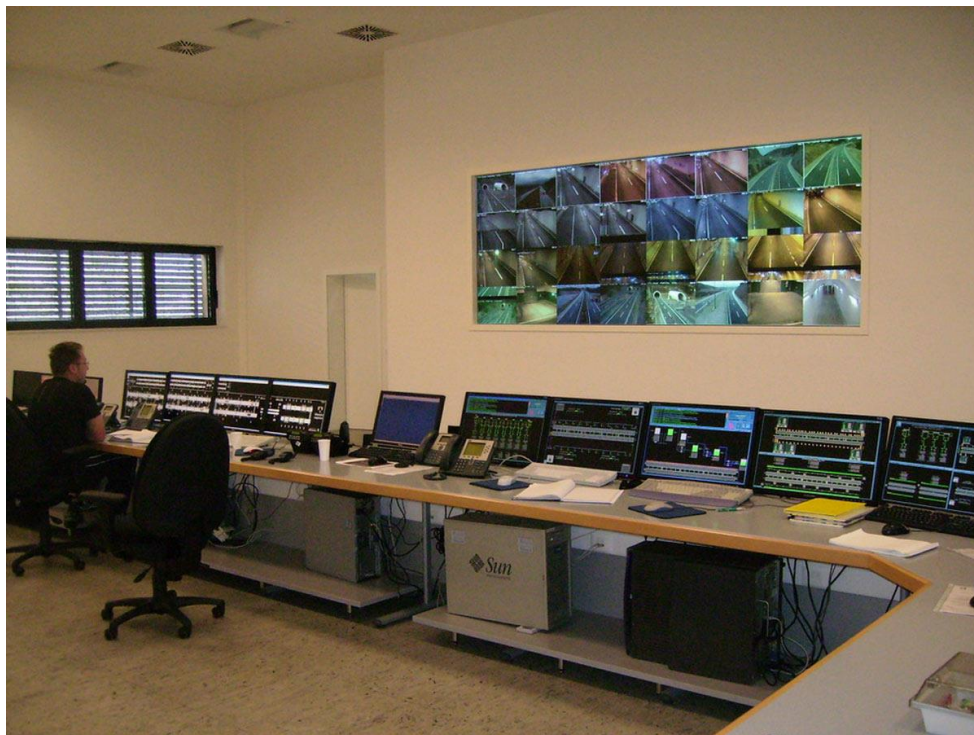
Slika 30. Glavni Operativni Centar za kontrolu i nadzor prometa (COKP) Sveti Rok Izvor: https://gin.hr/strucni-elektro-i-strojarski-nadzor-nad-opremanjem-tunela/
