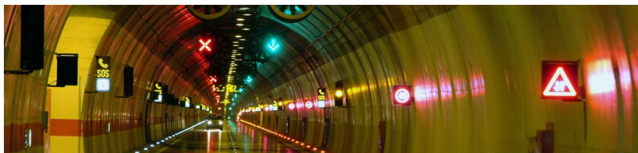
Slika 32. Prometna signalizacija u tunelu-svjetleći prometni znakovi Izvor: https://www.dalekovod.hr/tuneli.aspx
