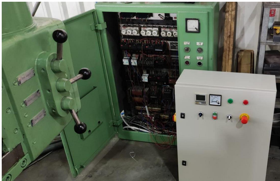
Slika 4.3. Stari i novi ormar
