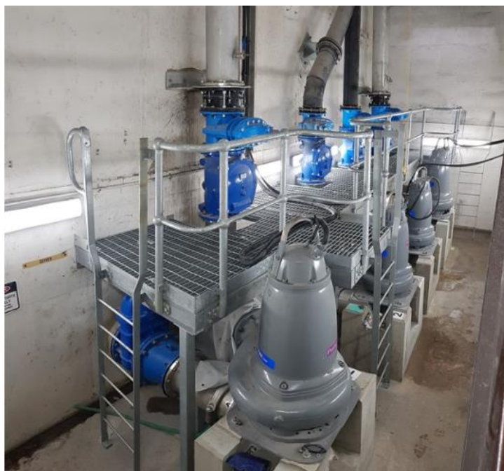
Slika 23. Strojarnica crpne stanice [29]
