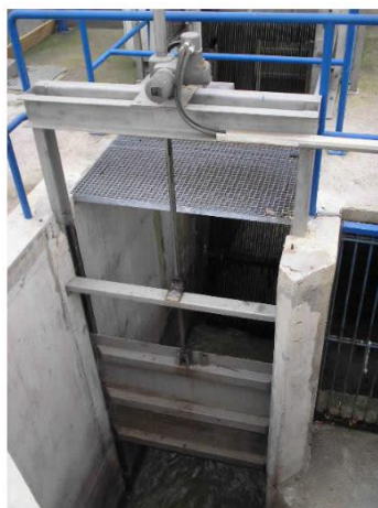
Slika 19. Automatska pločasta zapornica [25]
