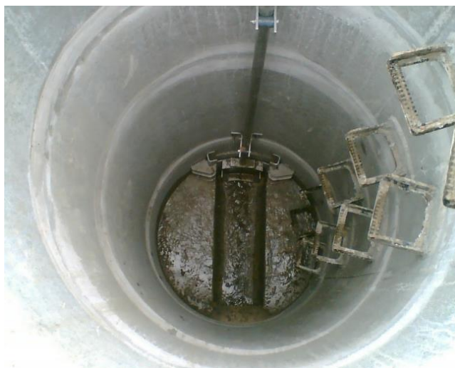
Slika 16. Primjer revizijskog okna [22]
