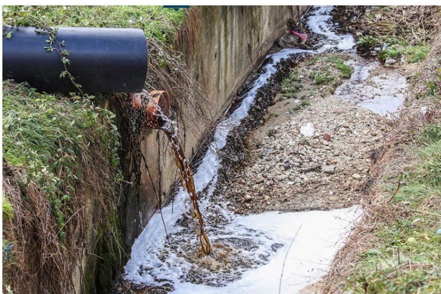
Slika 1. Nekontrolirano ispuštanje nepročišćenih otpadnih voda [2]
