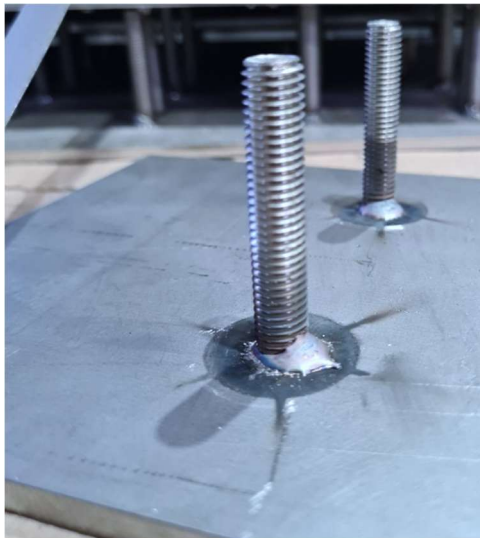
Slika 3.11. Nepravilan zavar svornjaka uzrokovan puhanjem luka
