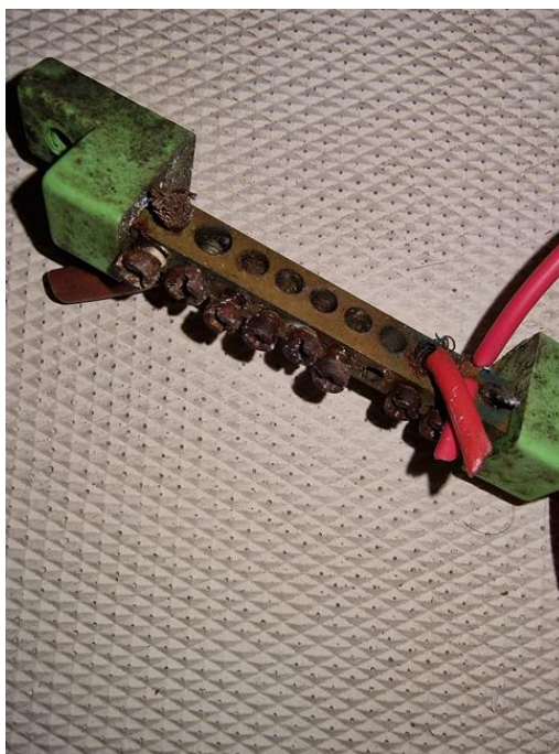
Slika 2 Korozija na sabirnici napajanja broda [2]
