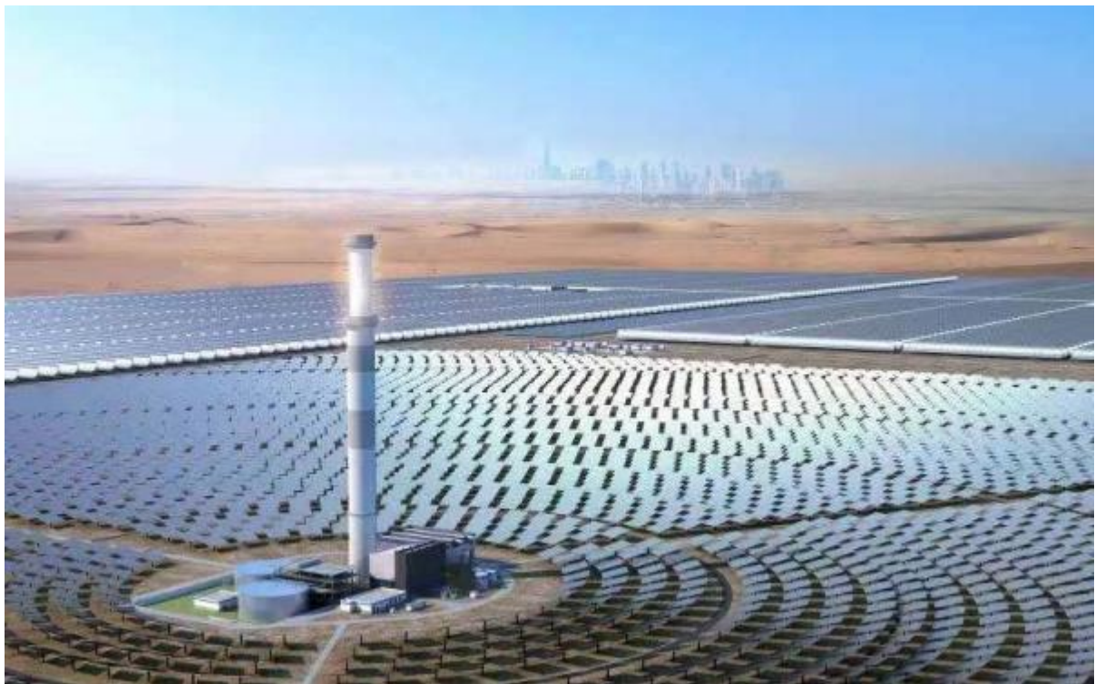
Slika 19 Elektrana sa solarnim tornjem
