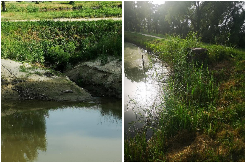
Slika 5.2.18. Propust za punjenje mrtvaje (21.06.2023.) [12]
