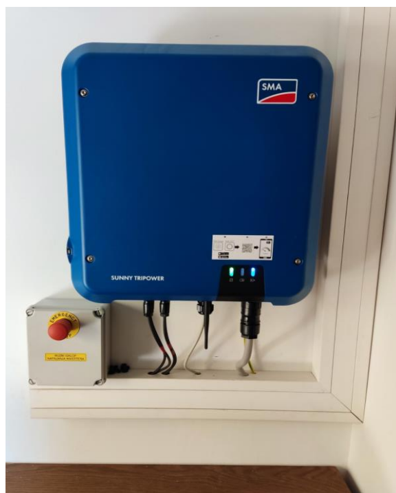
Slika 4.21. Instalirani predmetni inverter SMA SUNNY TRIPOWER 4.0
