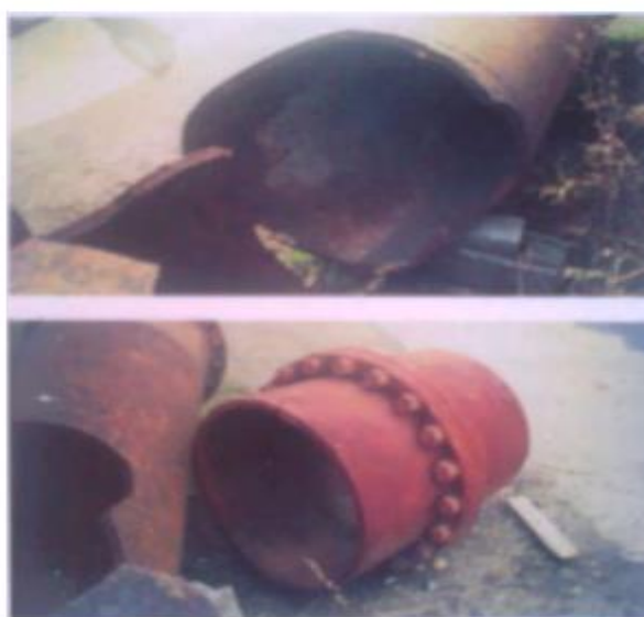
Slika 7.5. Izgleda cjevovoda nakon hidrauličkog udara [12]
