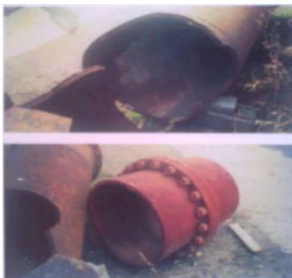
Slika 7.5. Izgleda cjevovoda nakon hidrauličkog udara [12]
