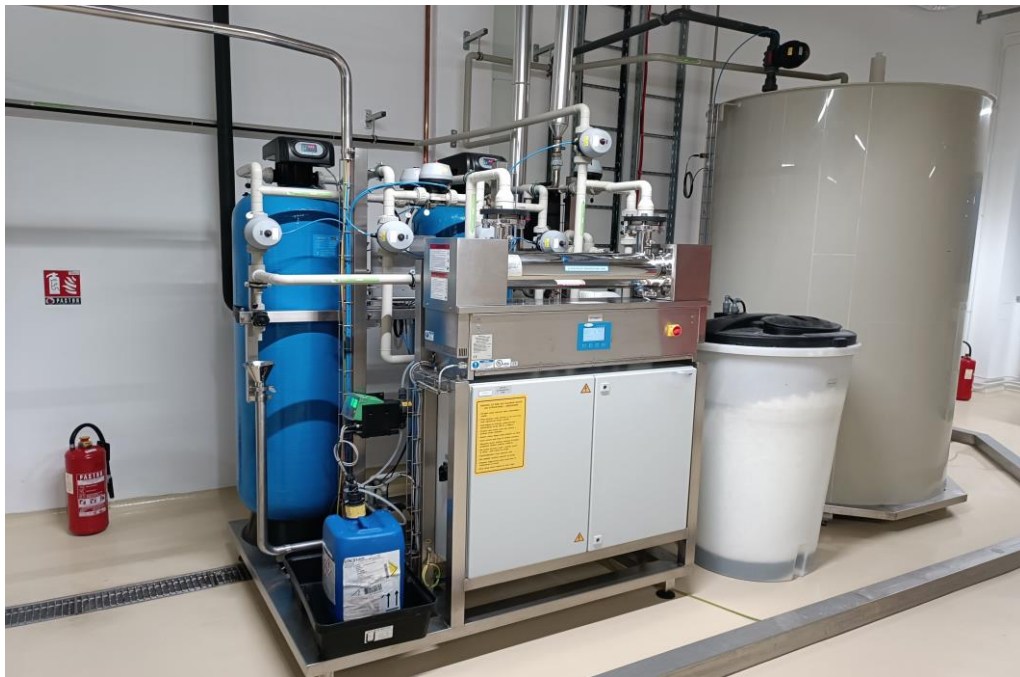
Slika 3. Predpriprema tehnološke vode (Izvor: Autor)
