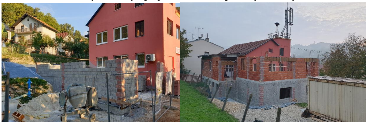
Slika 3.4.1 i 3.4.2. Prikazuju proces zidarskih radova
