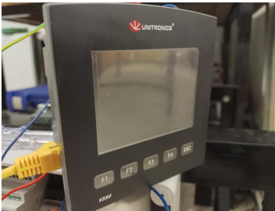
Slika 4.1.1. Unitronics V350 PLC+HMI
