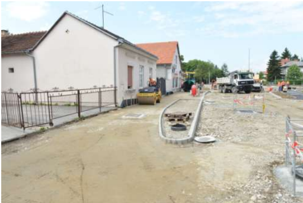
Slika 20. Ugradnja i zbijanje zrnatog kamenog materijala 0-60 mm (Izvor: PZC Varaždin d.d., arhiva fotografija, 2013.)
