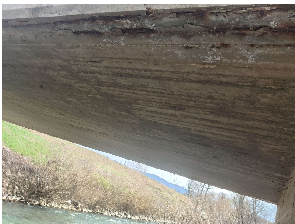
Slika 26: Ljuštenje betona s donje strane ploče (autorski rad)
