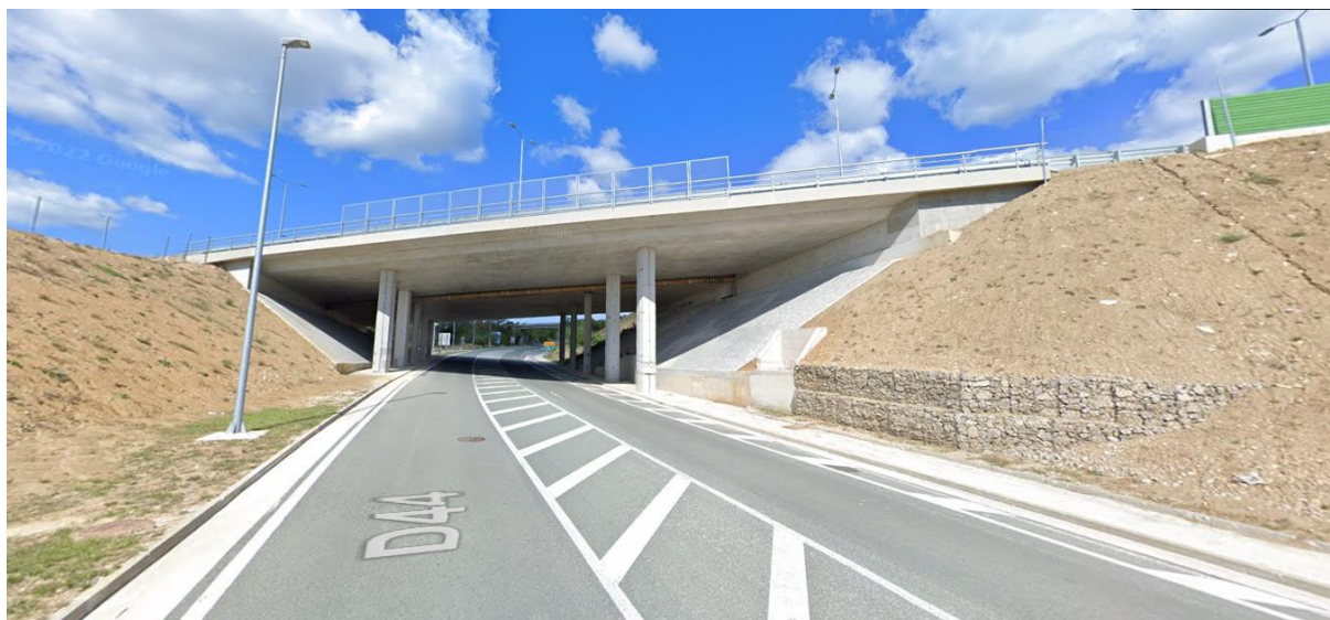
Slika 2.4 Cestovni nadvožnjak u općini Lupoglav, prevodi autocestu A8 preko državne ceste D44 (Izvor: Google karte)
