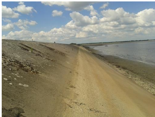
Slika 19. Stanje obloge prije sanacije
