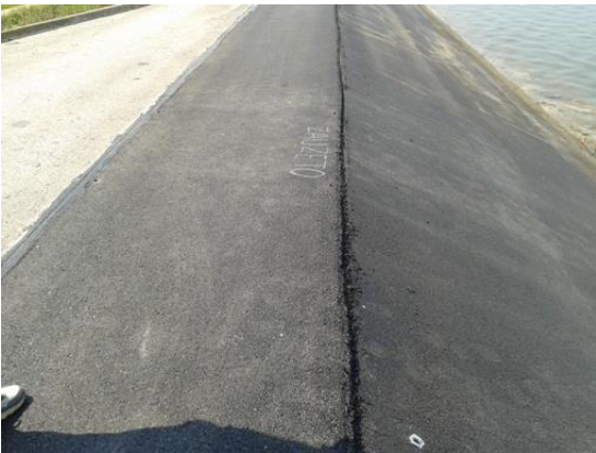
Slika 80. Detalj zapunjenog uzdužnog radnog spoja na kruni nasipa
