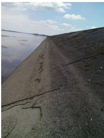
Slika 4. Oštećenje AB obloge
