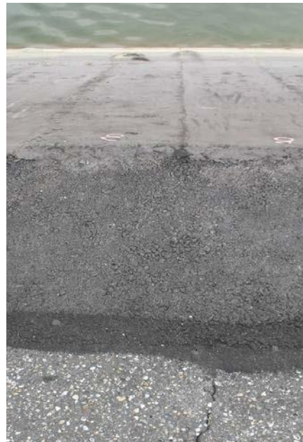
Slika 89. Pozicija „vodenog džepa“ ravno ispod otvorene pukotine na kruni nasipa
