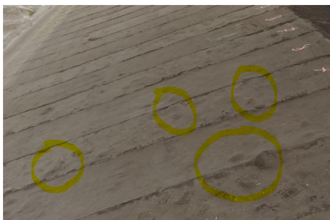
Slika 13. Oštećenja na površini mastiksa
