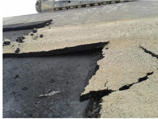
Slika 25. Loša povezanost postojećih asfaltnih slojeva
