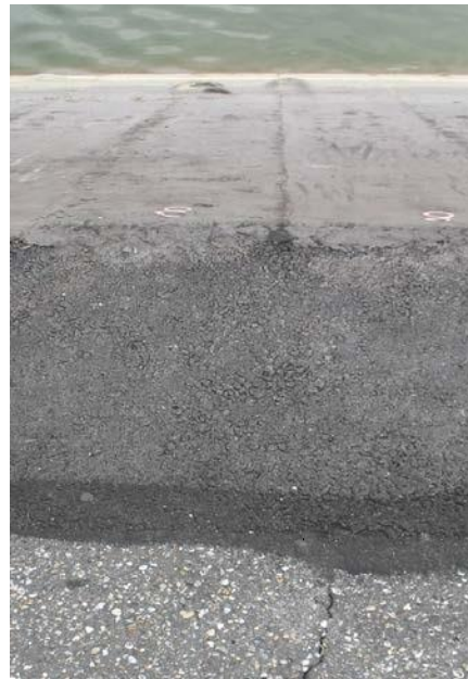
Slika 89. Pozicija „vodenog džepa“ ravno ispod otvorene pukotine na kruni nasipa
