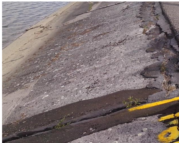
Slika 5. Oštećenje AB obloge
