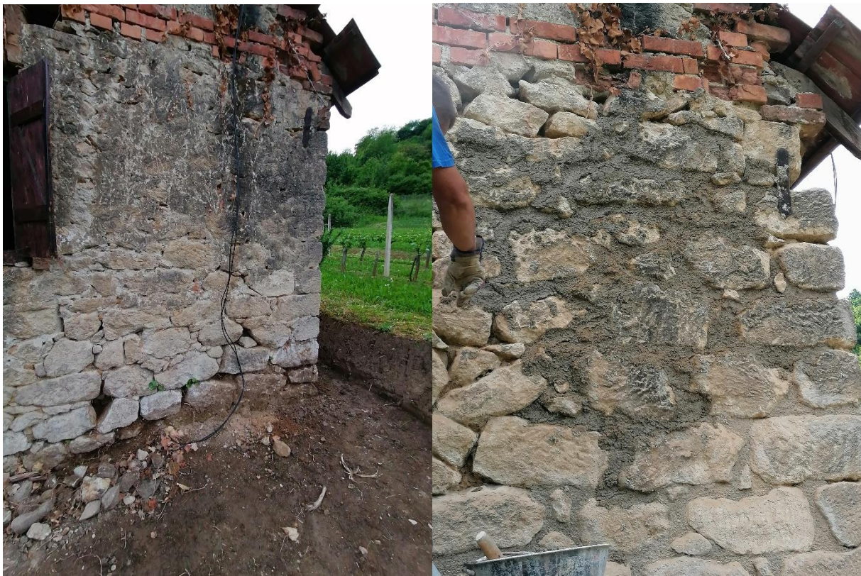
Slika 5.11: Stanje zidova prije i tijekom fugiranja
