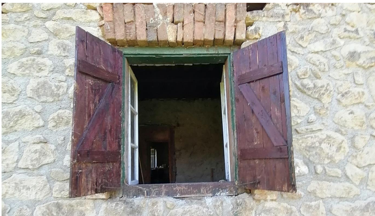
Slika 3.30: Izgled nadvoja prije restauracije
