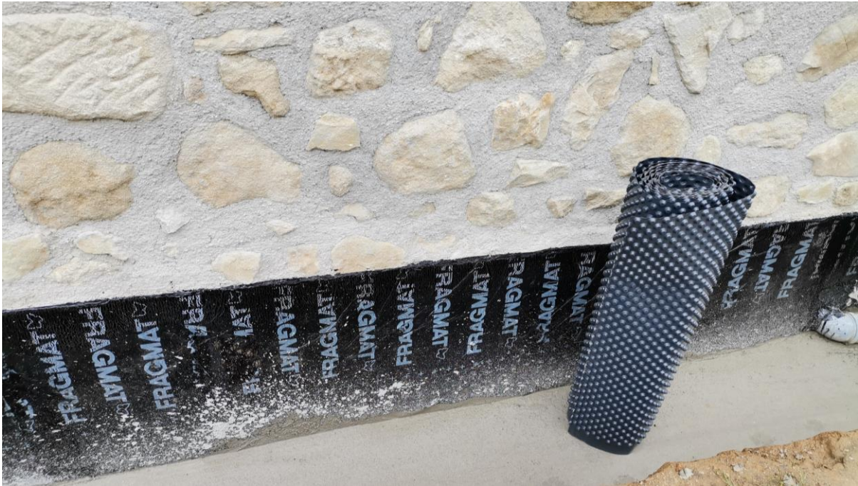
Slika 5.5: Bitumenska ljepka, čepasta folija i betonska podloga
