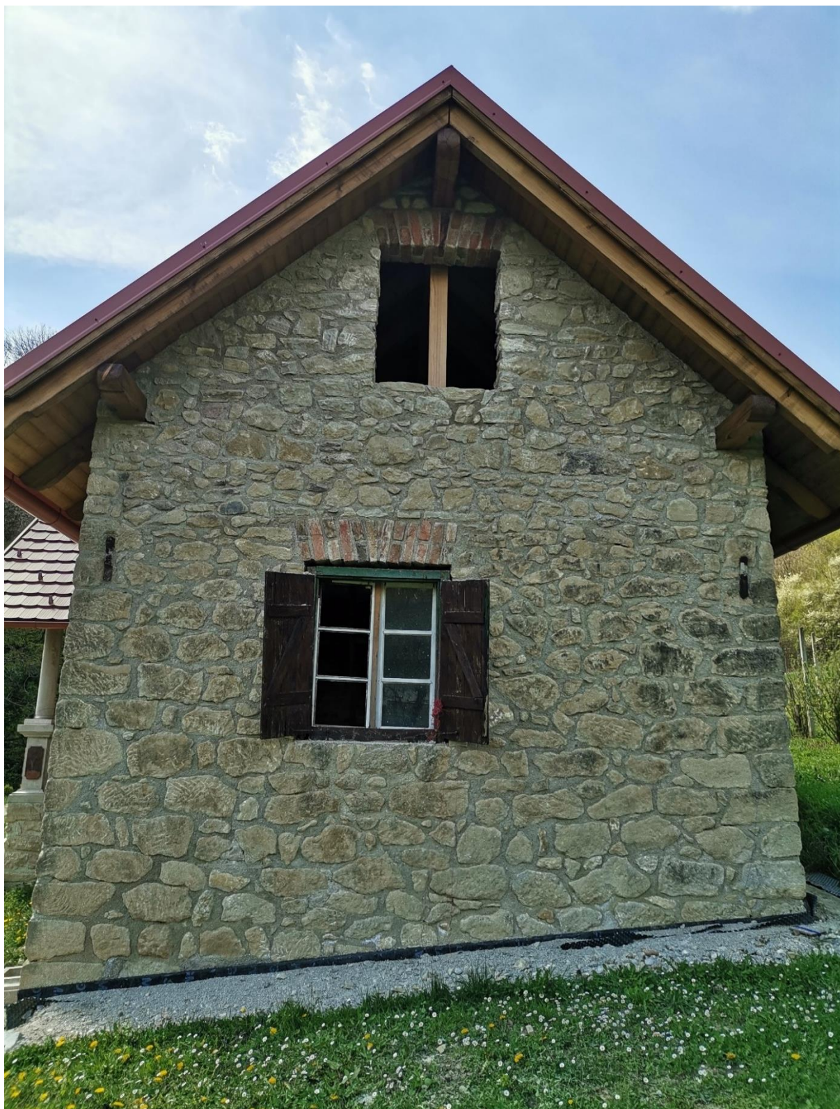
Slika 5.68: Prikaz konačnog izgleda nadvoja od opeke (donji prozor) i nadvoja od armiranog betona i opeke (gornji prozor)
