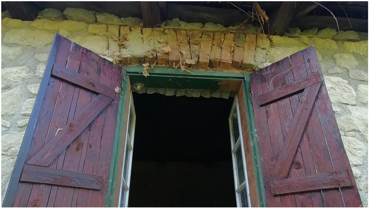
Slika 5.59: Izgled nadvoja prije restauracije
